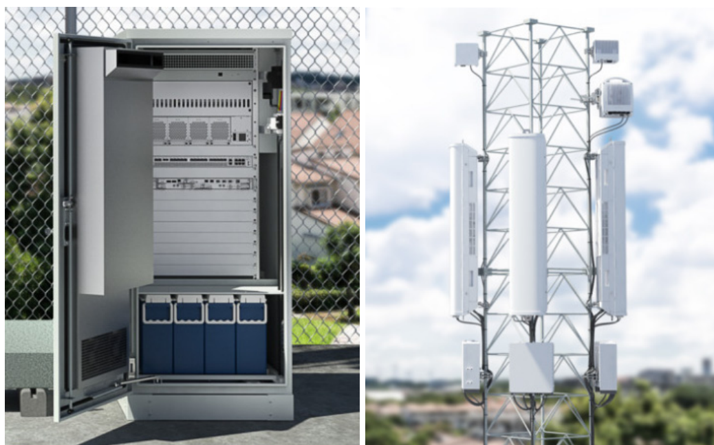
(a) Cabinet de uma estação base contendo BBU, baterias e controlo climático. (b) Três antenas com as respetivas RRUs no topo da torre.
