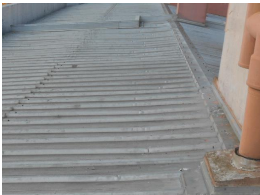
Figura 60 - Fotografia da cobertura antes da intervenção (chapas danificadas)
