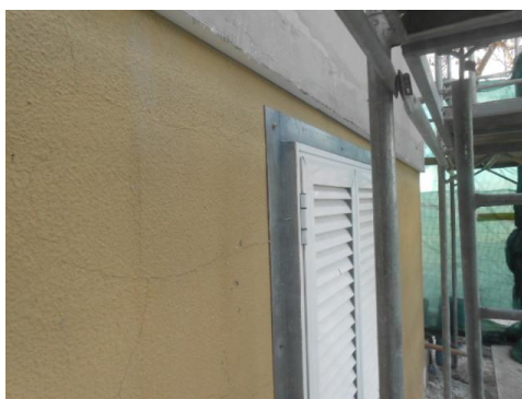
Figura 44 - Chapa de aço utilizada para vencer o aumento de espessura das paredes após intervenção com o sistema ETICS
