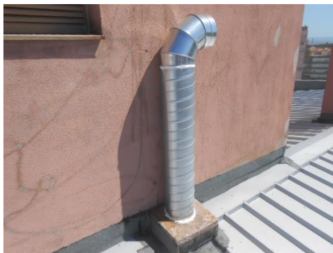
Figura 65 - Chaminé de ventilação em aço galvanizado
