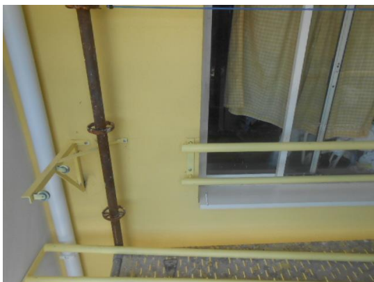
Figura 7 - Estendal da roupa e guardas metálicas em janela
