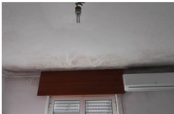
Figura 61 - Interior de uma habitação no local onde encontra a caleira (infiltrações)
