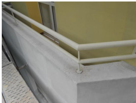
Figura 37 - Exemplo de aplicação de uma guarda metálica
