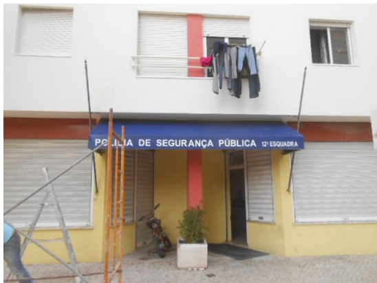
Figura 12 - Toldo da esquadra da polícia que necessita ser removido
