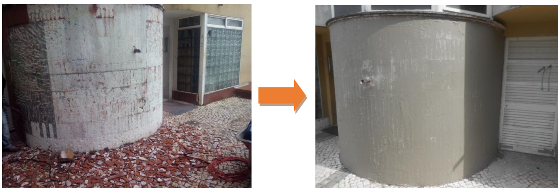
Figura 16 - Exemplo de aplicação da argamassa de renovação no núcleo exterior de escadas
