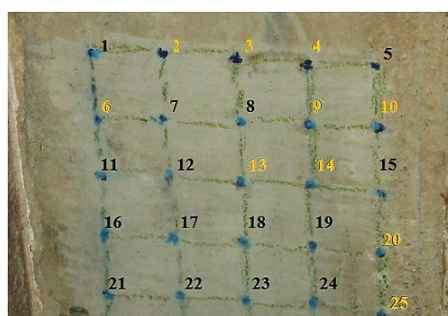
Figura 4.84 – Representação das zonas das medições efetuadas pelo aparelho Esclerómetro Schmidt , do pilarete nº 2, do segundo piso.
