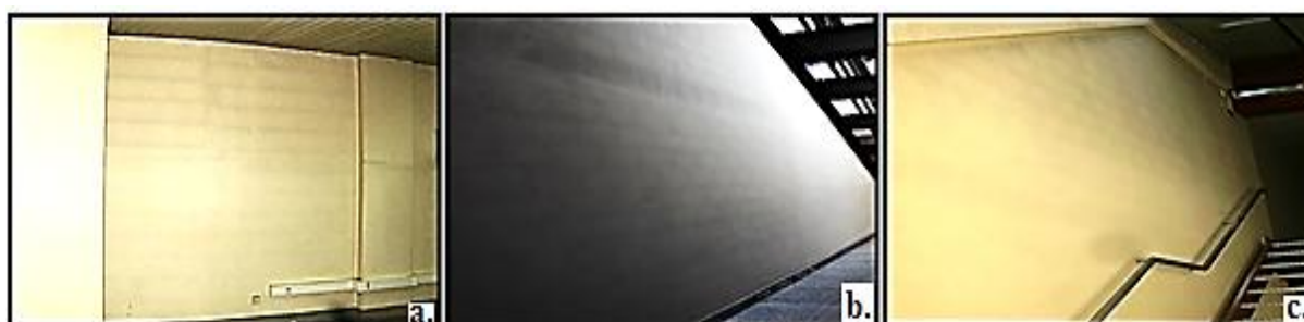
Figura 4.54 - a. Ocorrência de anomalia A.6. no Grupo I de pisos: a. Em parede nascente do rés-do-chão; b. Em parede exterior norte, do primeiro piso; c. Em parede exterior sul, do primeiro piso
