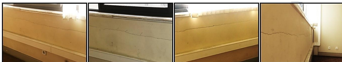
Figura 4.49 - Ocorrência da anomalia A.1.(8) no primeiro piso.
