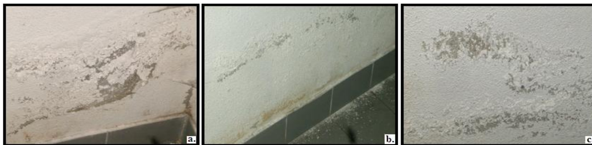
Figura 4.30 - Ocorrência da anomalia A.11: a. No piso -2; b.; c. No piso -1.
