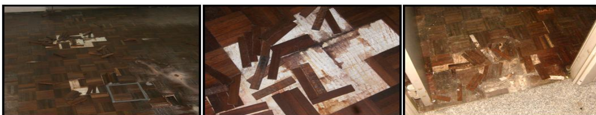
Figura 4.43 - Ocorrências de anomalias B.1.(1) no rés-do-chão e no primeiro piso.
