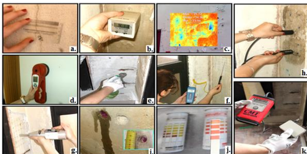
Figura 4.25 - Técnicas de diagnóstico utilizadas no edifício: a. TD-1-AVA-1; b. TD-2-ND-1; c. TD-2-ND-2; d. TD-2-ND-3; e. TD-2-ND-4; f. TD-2-ND-5; g. TD-2-ND-6; h. TD-2-ND-7; i. TD-2-ND-8; j. TD-3-IPS-1; k. TD-2-ND-9.
