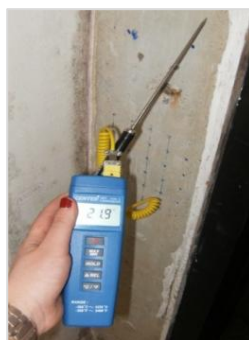
Figura 3.30 - Representação da medição de temperatura no pilarete nº2 no segundo piso, do edifício em estudo.
