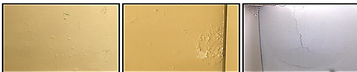
Figura 4.73 - Ocorrências da anomalia A.7.(4) .
