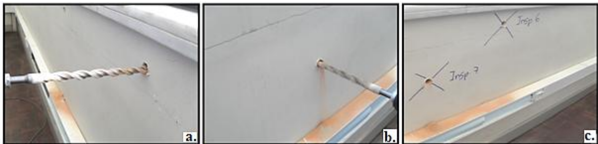
Figura 4.71 - Representação das inspeções realizadas em paredes exteriores no segundo piso: a. Inspeção nº 6; b. Inspeção nº7; c. Realização das inspeções nº6 e nº7.
