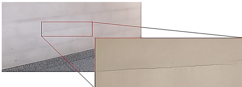
Figura 4.72 - Ocorrência da anomalia A.1.(11).
