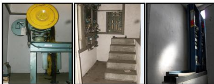
Figura 4.21 - Representação de alguns elementos presentes na casa das máquinas, localizado no nono piso.
