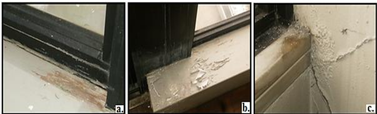
Figura 4.80- Ocorrências da anomalia D.3.(2).
