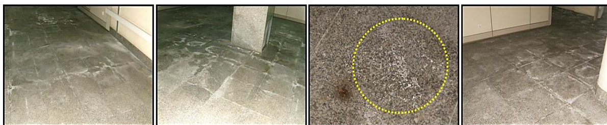
Figura 4.44 - Ocorrência de anomalias C.1.(1) no rés-do-chão e no primeiro piso.
