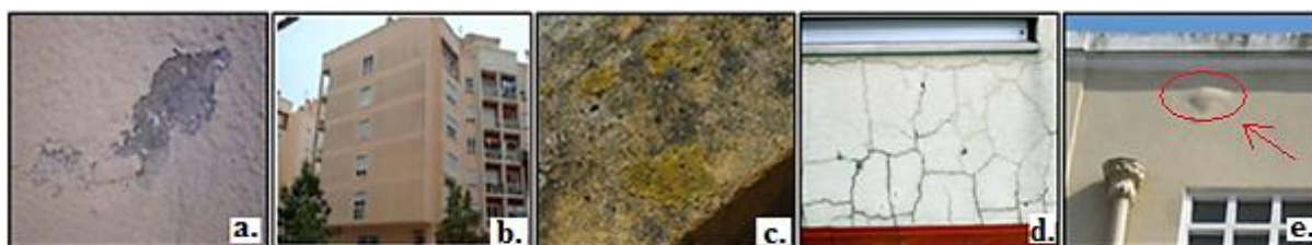
Figura 2.13 - Representação de algumas anomalias correntes em rebocos (Flores-Colen, 2008): a. Criptoflorescência, b. “Fantasmas”; c. Formação biológica – Líquenes; d. Fissuração mapeada; e. Deformação ou empolamento.
