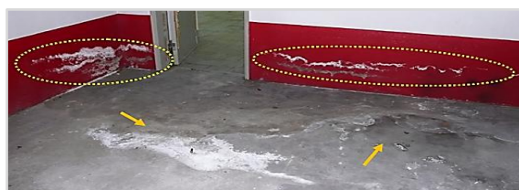
Figura 4.37 - Representação das manchas de água no pavimento, próximas dos locais de ocorrência da anomalia A.4.(2).
