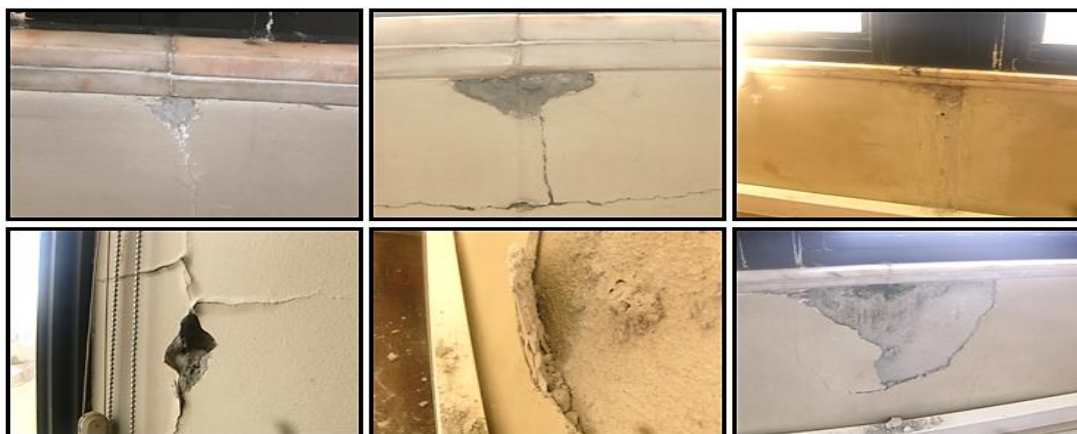
Figura 4.66 - Ocorrências da anomalia A.5(2).
