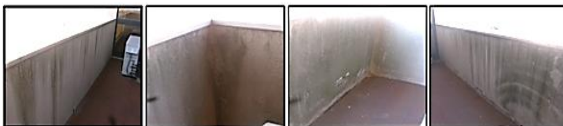
Figura 4.99 - Ocorrências da anomalia A.12.(2).
