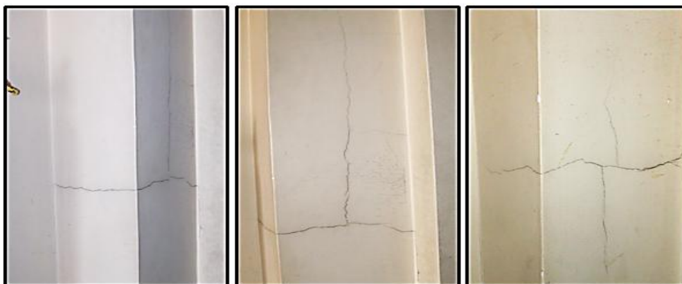
Figura 4.91 - Ocorrências da anomalia G.1.(1).
