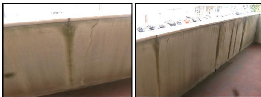
Figura 4.78 - Ocorrência da anomalia A.12.(1).
