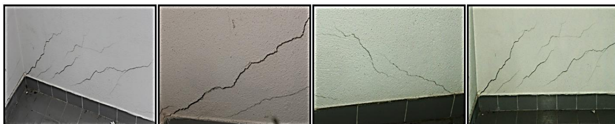
Figura 4.34 – Ocorrências da anomalia A.1.(1).
