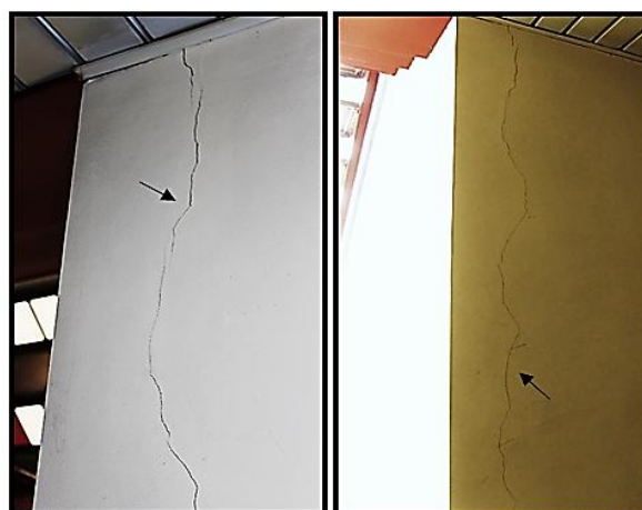
Figura 4.46 - Ocorrência da anomalia A.1.(7).
