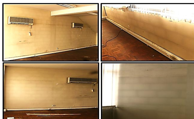
Figura 4.120 - Ocorrências da anomalia A.6.(4).
