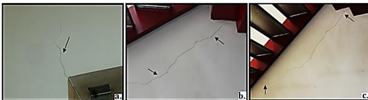
Figura 4.42 - Ocorrência de algumas anomalias A.1. no rés-do-chão e no primeiro piso: a. Anomalia A.1.(6); b.; c. Anomalia A.1.(9).
