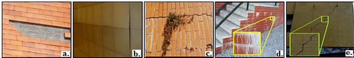
Figura 2.15 - Representação de anomalias em revestimentos cerâmicos: a. Destacamento (Silvestre, 2005); b. Empolamento (Silvestre, 2005); c. Colonização biológica (Silvestre, 2005); d. Eflorescências (Sousa, 2008); e. Fissuração (Silvestre, 2005).
