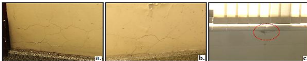
Figura 4.50 – Representação de algumas anomalias no primeiro piso: a.; b. - Ocorrências da anomalia A.2.(1); c. Ocorrência da anomalia A.5.(1).
