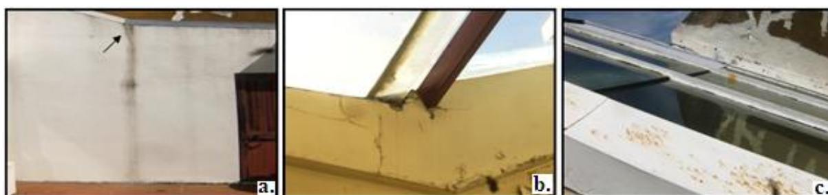
Figura 4.52 - a. Paramento exterior da parede de alvenaria degradada; b. Representação das degradações manifestadas pela infiltração de água através do lanternim; c. Degradação exterior do lanternim.
