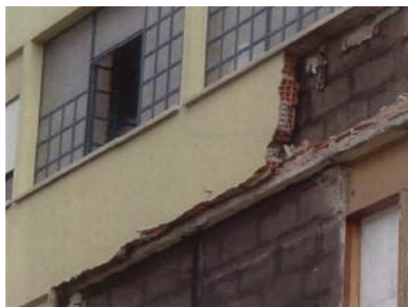
Fig. 3.8 Colapso de um pano de parede [7]
