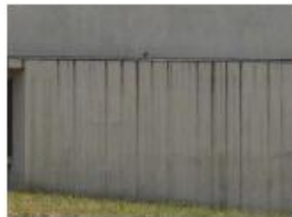
Fig. 5.10 Manchas de escorrimento [25]
