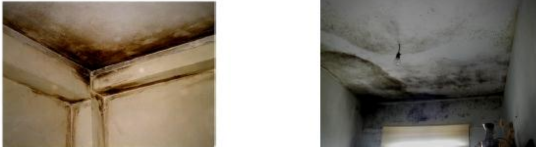
Fig. 3.1 Condensações e bolores em zonas de ponte térmica [7]
