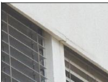
Fissuração ritmada do revestimento sobre cantoneira de arranque
