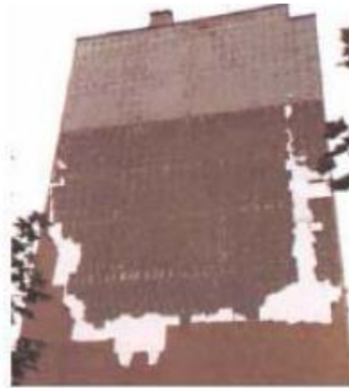
Fig. 5.23 Dessolidarização e queda generalizada do sistema [22]
