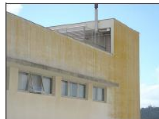
Fixação de líquenes em fachadas
