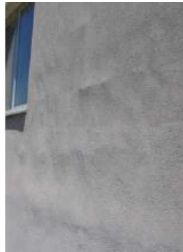
Fig. 5.19 Empolamento das placas [25]
