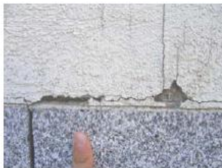
Fig. 5.20 Degradação do recobrimento do perfil de arranque [25]
