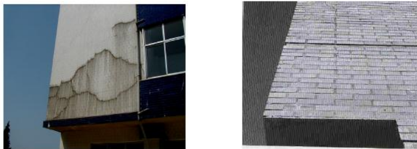
Fig. 3.7 Fissuração verificada na zona da parede apoiada em laje em consola [7]
