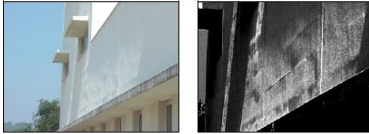
Fig. 5.12 Falta de planeza do sistema [25]
