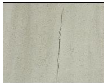
Fissuração entre juntas de placas
