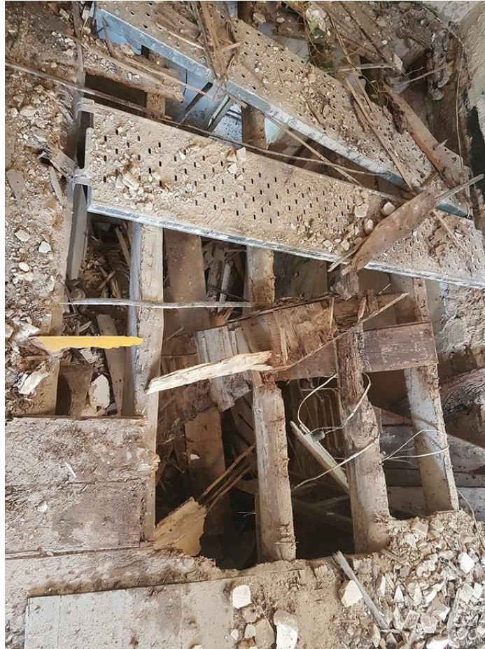
Figura 33 - demonstração do estado de degradação do soalho da laje
