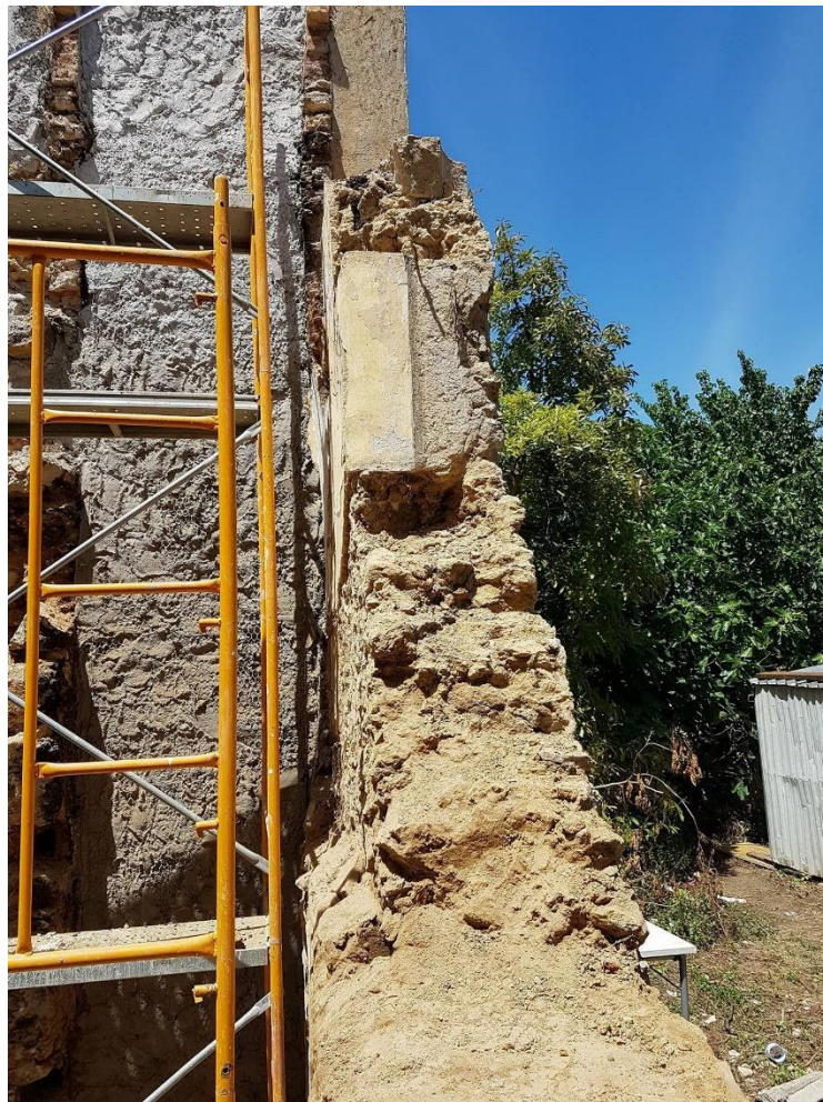
Figura 38 - escoramento da empena do edifício adjacente
