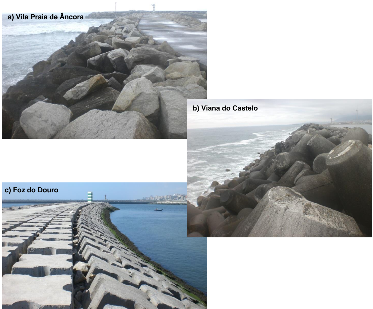
Figura 1.2 – Exemplos de quebra-mares de taludes protegidos por a) enrocamento, b) e c) blocos artificiais
