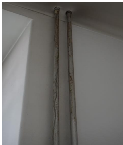
Figura nº 4 – Oxidação das redes de abastecimento de água fria
