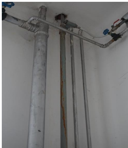
Figura nº 9 – Oxidação das redes de abastecimento de água fria
