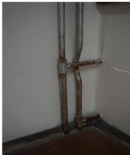
Figura nº 2 – Oxidação das redes de abastecimento de água fria
