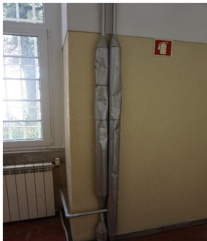
Figura nº 1 – Deformação das redes de abastecimento de água quente
