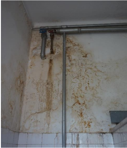
Figura nº 5 – Oxidação das redes de abastecimento de água quente
