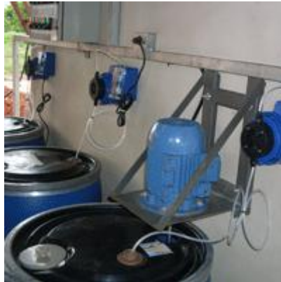
Figura 20 - Depósito e doseador de hipoclorito de sódio
