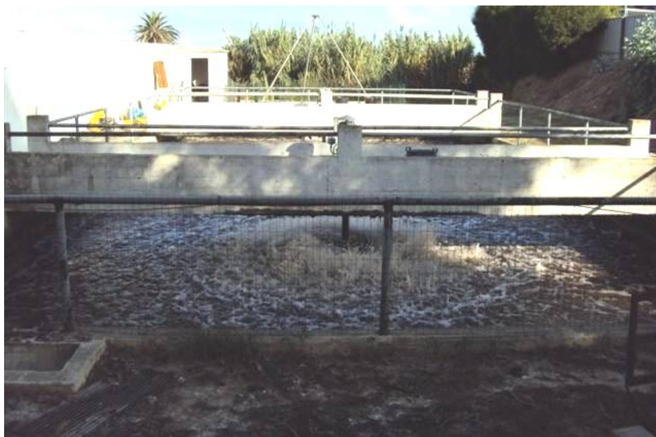
Figura 18 - ETAR em funcionamento no empreendimento
