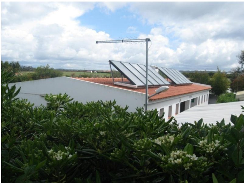
Figura 2 - Painéis Solares para aquecimento de águas Sanitárias
