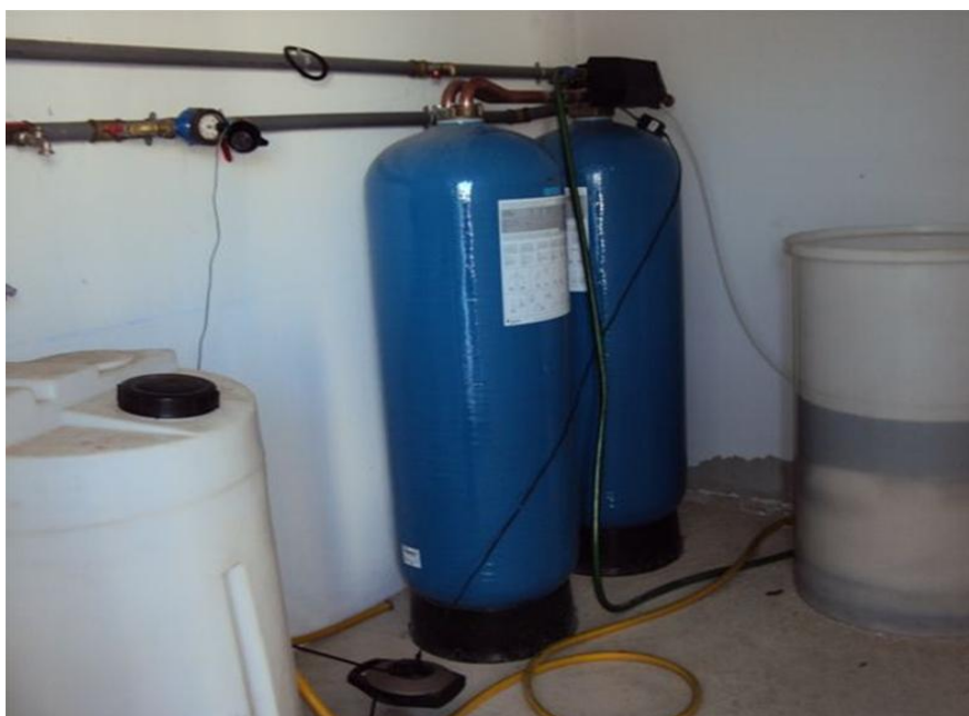
Figura 14 - Instalação de amaciamento em funcionamento no Hotel Porto Covo
