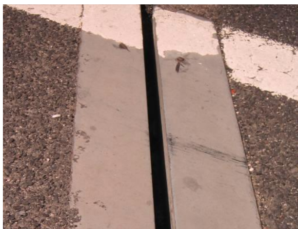
Figura 8 – Junta de dilatação aberta [6]
