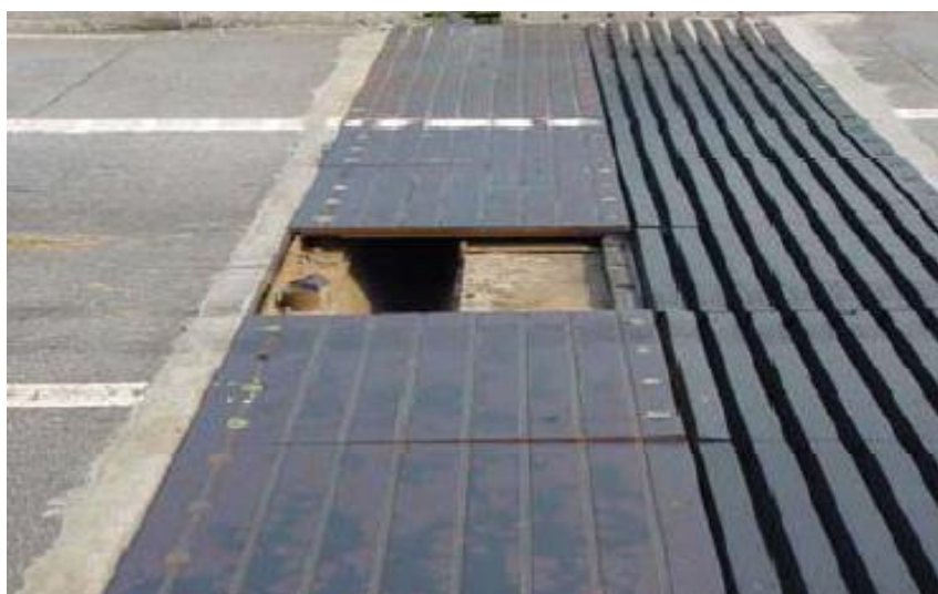
Figura 50 – Desaperto de fixações na junta de dilatação [7]
