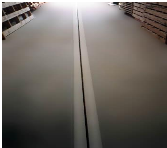
Figura 3 – Junta de dilatação horizontal [ http://colegiodearquitetos.com.br ]
