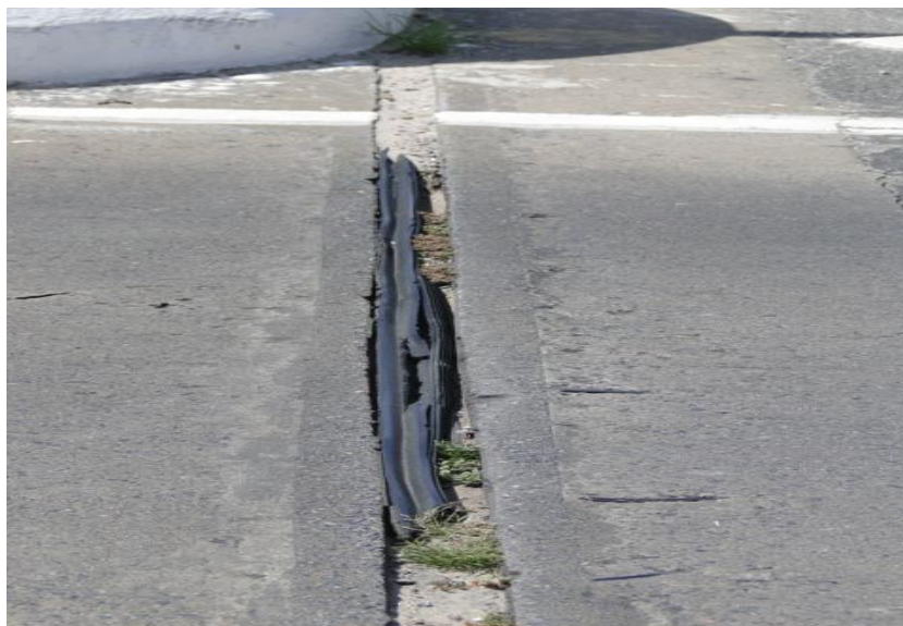
Figura 53 – Falta de aderência e formação de ruído da junta de dilatação [8]
