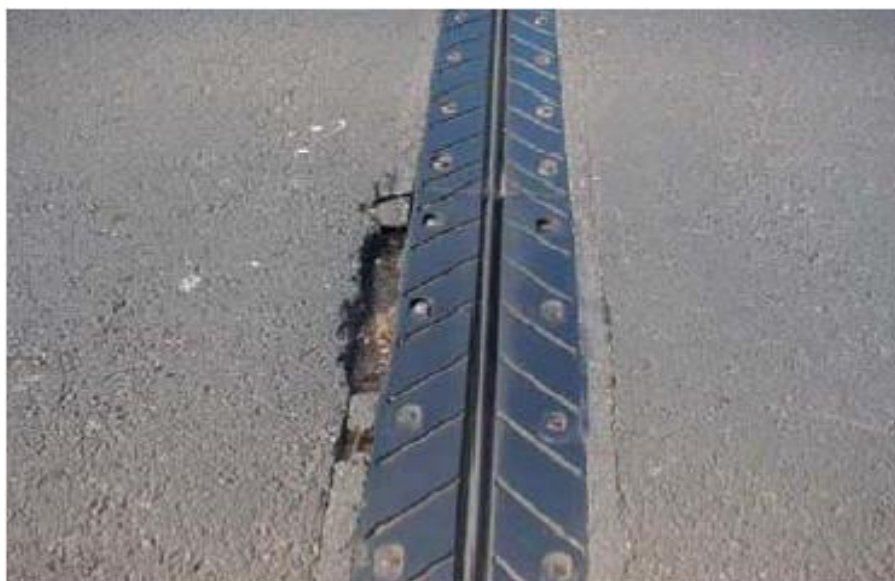
Figura 47 – Degradação da camada de transição entre a junta de dilatação e o pavimento [7]
