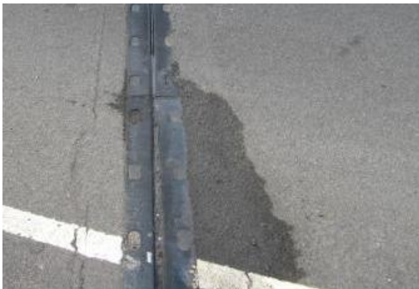
Figura 52 – Falta de estanquicidade na junta de dilatação [7]
