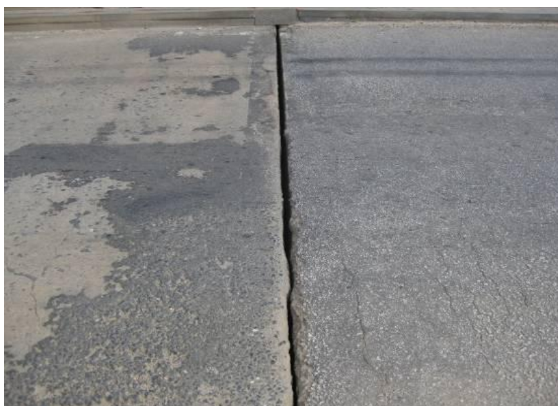
Figura 51 – Ausência de junta de dilatação [37]
