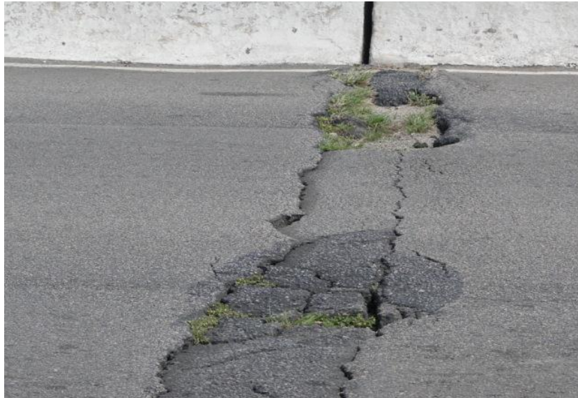
Figura 48 – Desnívelamento da junta de dilatação relativamente ao pavimento [8]
