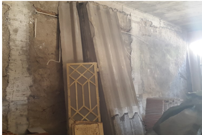
Figura 39 - Fibrocimento com amianto
