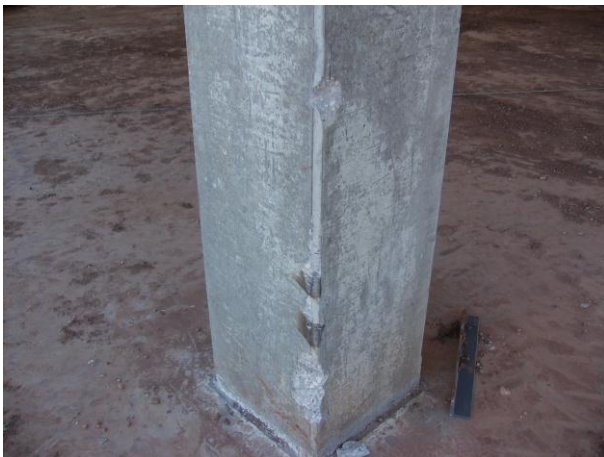
Figura 94 – Pilar danificado devido a choque da empilhadora telescópica
