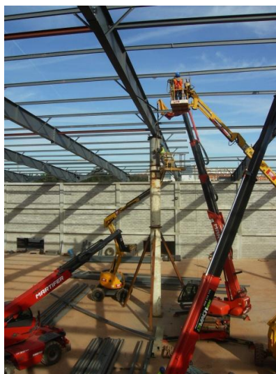
Figura 52 – Execução de vários trabalhos com grande proximidade
