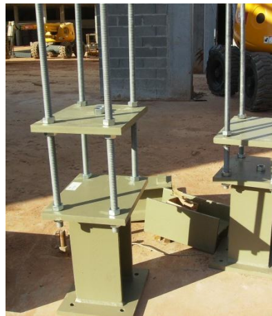
Figura 61 – Peças de apoio à montagem das asnas nos alinhamentos B e Q
