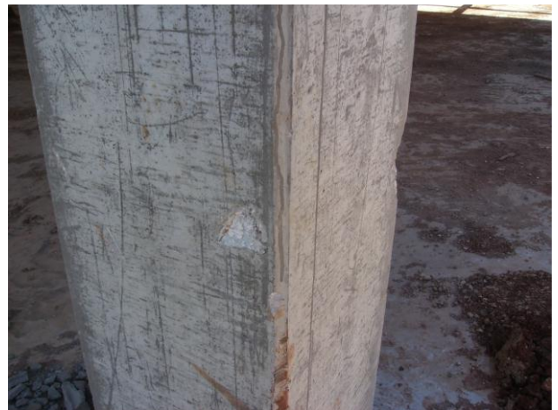
Figura 95 – Segundo pilar danificado devido a choque da empilhadora telescópica
