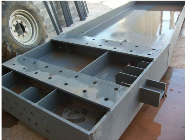
Figura 45 – Acumulação de água sobre uma peça
