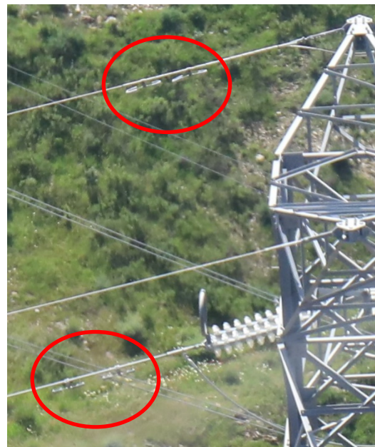
Figura 2.34 - Amortecedores Stockbridge instalados em cabos
