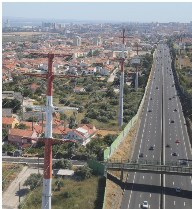
Figura 2.18 – Linha dupla de 220kV com apoios tubulares
