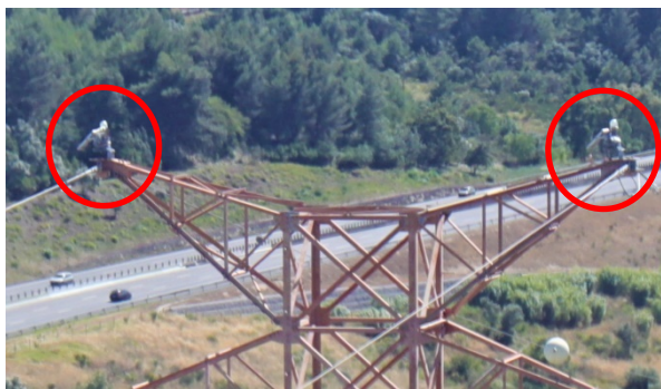
Figura 2.39 - Luminárias de obstrução com painel solar em apoio reticulado
