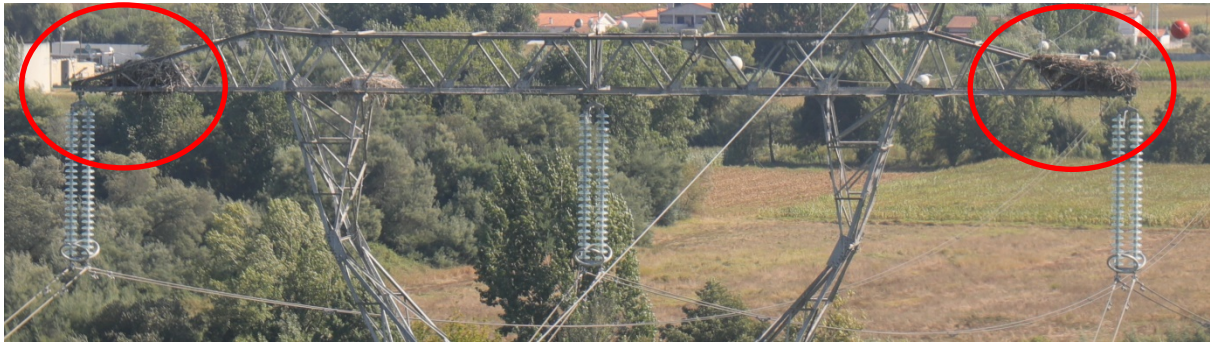
Figura 2.41 - Ninhos de cegonha em locais de risco
