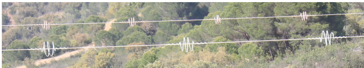
Figura 2.40 - BFD's Instalados em linha com dois cabos de guarda
