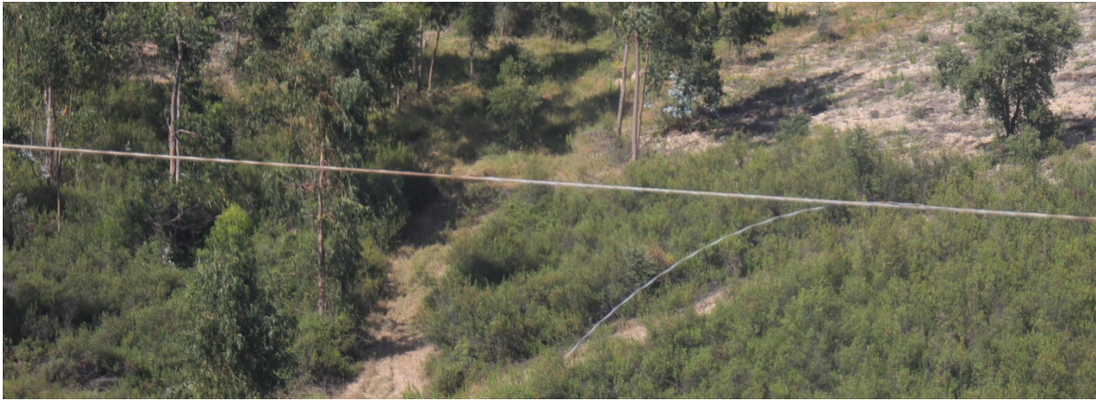
Figura 3.11 - Cabo de guarda com corrosão e desfiado
