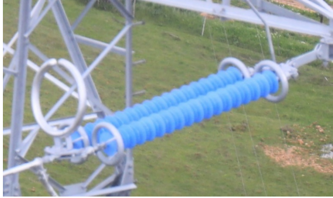
Figura 2.21 - Isolador rígido numa linha aérea de 220kV
