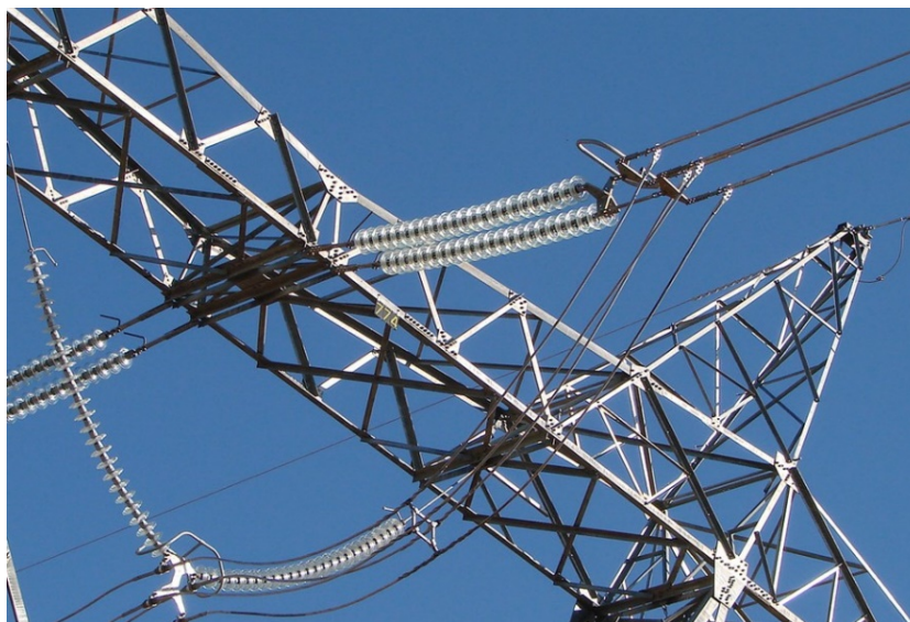
Figura 2.12 - Cabo condutor em feixe quádruplo
