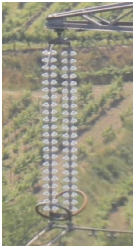
Figura 3.15 - Anéis de guarda com corrosão
