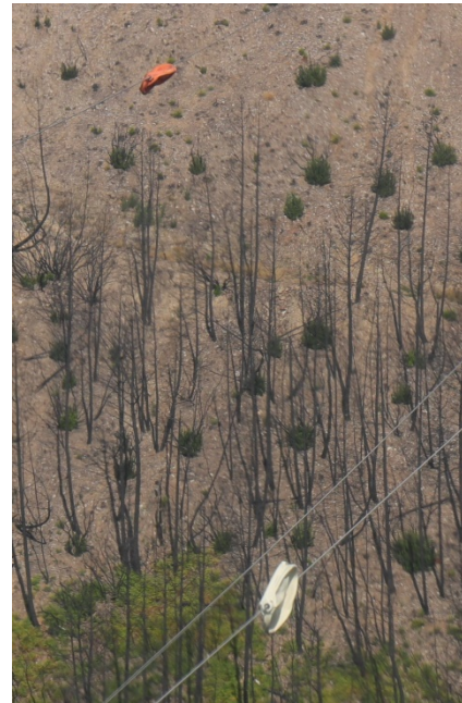
Figura 3.9 - Esferas de sinalização derretidas
