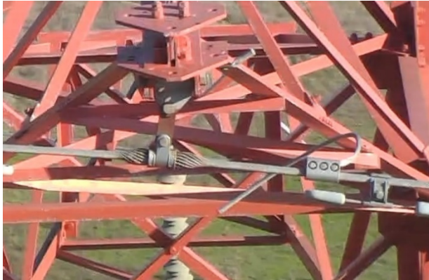
Figura 3.6 - Fiador cabo de guarda solto
