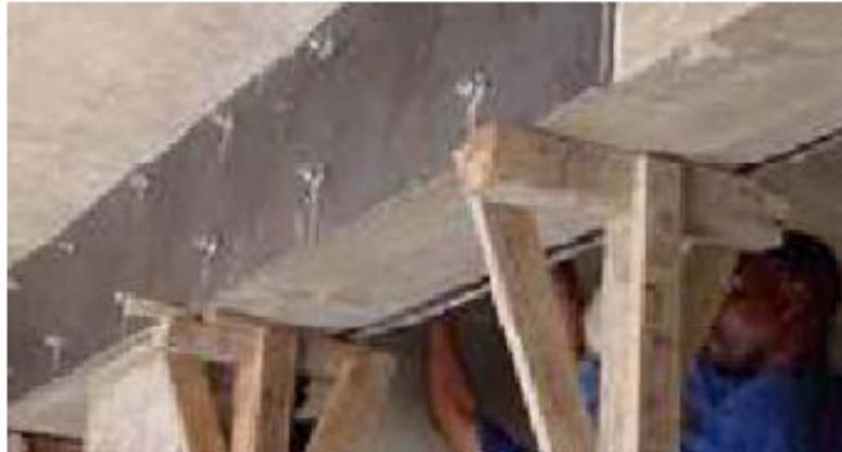
Figura 2.11 Pormenor do reforço de uma viga ao esforço transverso por adição de armaduras exteriores (Rodrigues, 2005).
