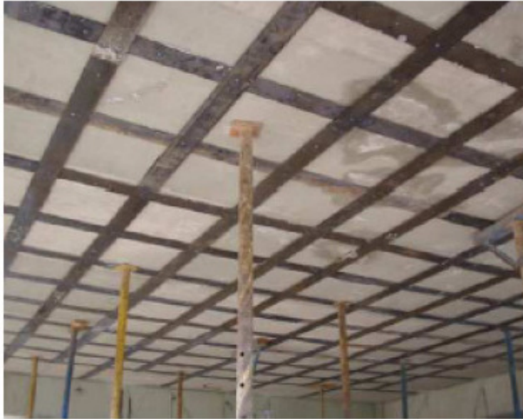
Figura 2.14 Reforço de uma laje com recurso a adição de chapas de aço (Rodrigues, 2005).
