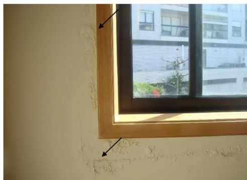
Figura 6. Exemplo de efeitos da humidade de precipitação em uma construção.
