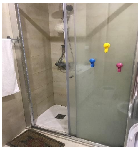
Figura 26. Casa de banho do edifício B apresentando efeitos da humidade
