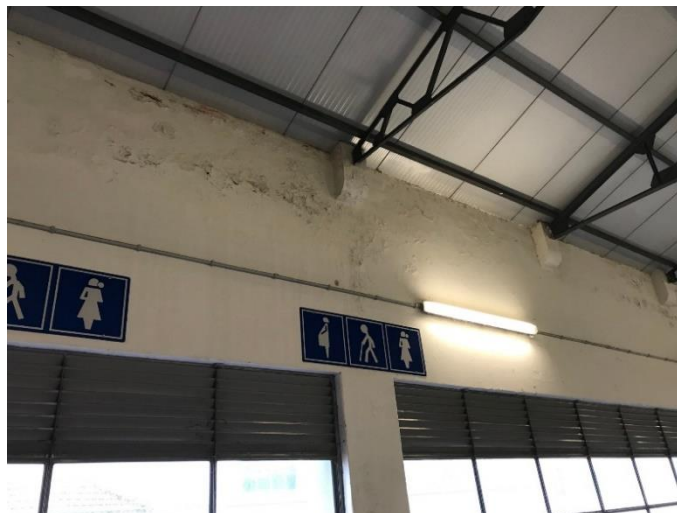
Figura 31. Vista 2 de uma parede do edifício C apresentando sinais da ação da humidade
