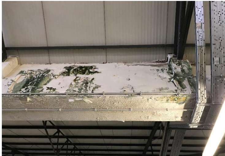
Figura 29. Cobertura do parque de estacionamento do edifício C apresentando sinais da ação da humidade
