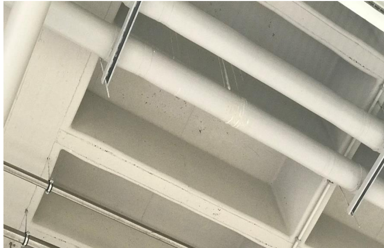
Figura 34. Teto do piso 0 com presença de estalactites (Imagem do autor)
