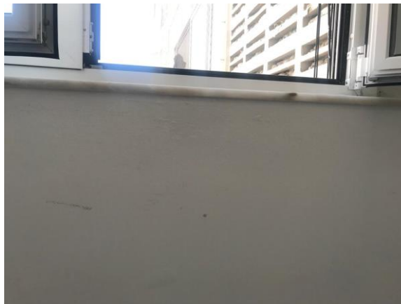
Figura 27. Sala de estar do edifício B apresentando sinais da humidade de precipitação
