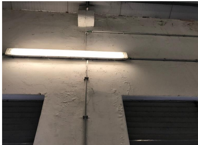
Figura 32. Vista 3 de uma parede do edifício C apresentando sinais da ação da humidade (Imagem do autor)
