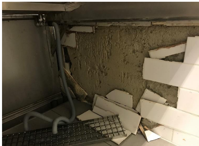
Figura 33. Descolamento de mosaico cerâmico e trincas no paramento interior do edifício (Imagem do autor)
