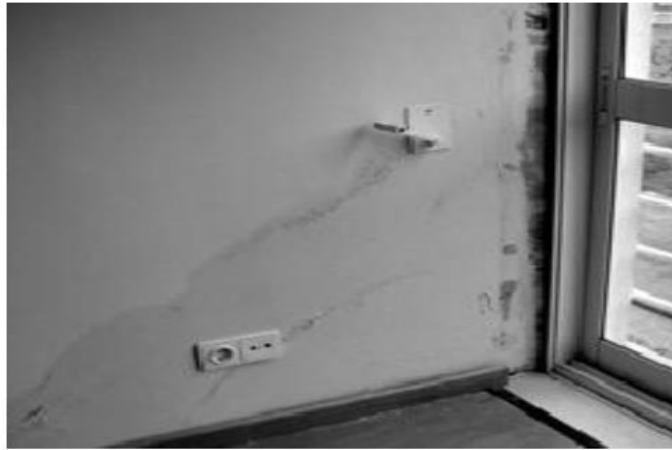
Figura 5. Exemplo de efeitos da humidade ascensional em uma parede.
