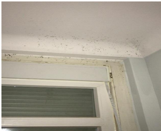
Figura 23. Caixa de estores do quarto do edifício A apresentando efeitos da humidade (Imagem do autor)
