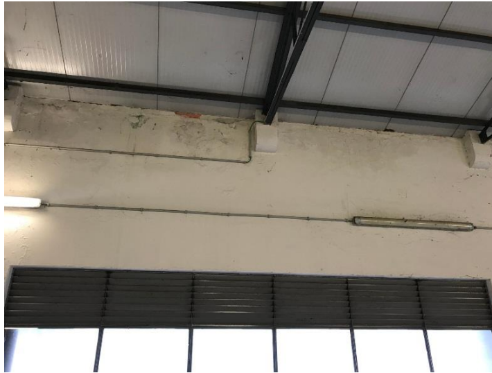
Figura 30. Vista 1 de uma parede do edifício C apresentando sinais da ação da humidade
