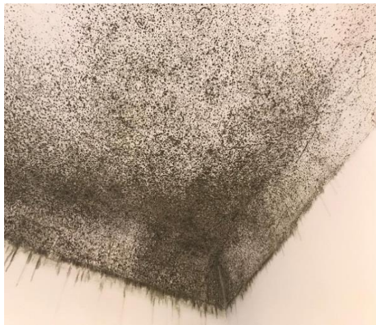
Figura 22. Teto da casa de banho do edifício A apresentando efeitos da humidade (Imagem do autor)
