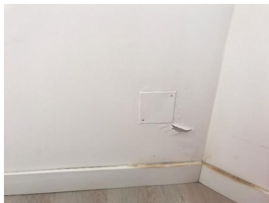
Figura 28. Sala de estar do edifício B apresentando sinais da humidade de precipitação
