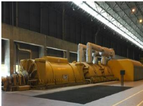
(a) Turbina de vapor
