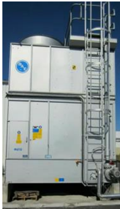
Figura 3: Condensador evaporativo [BAC]
