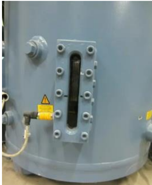
Figura 9: Pormenor do nível de óleo no separador [Genieclimatique]
