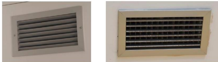
Figura 2 – Grelhas de distribuição existentes no edifício: uma em devidas condições de limpeza e outra a necessitar de manutenção.
