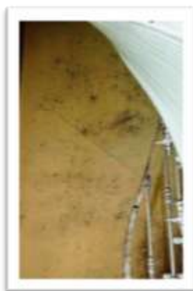
Figura 50 - Condensações em Paredes Interiores
