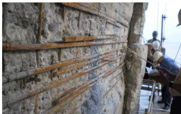
Figura 53 - Oxidação das Armaduras
