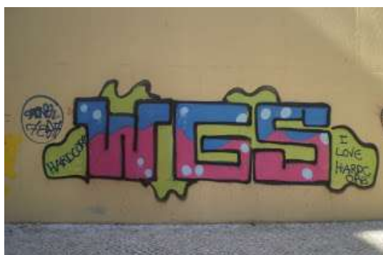
Figura 47 - Graffiti em Paredes Exteriores
