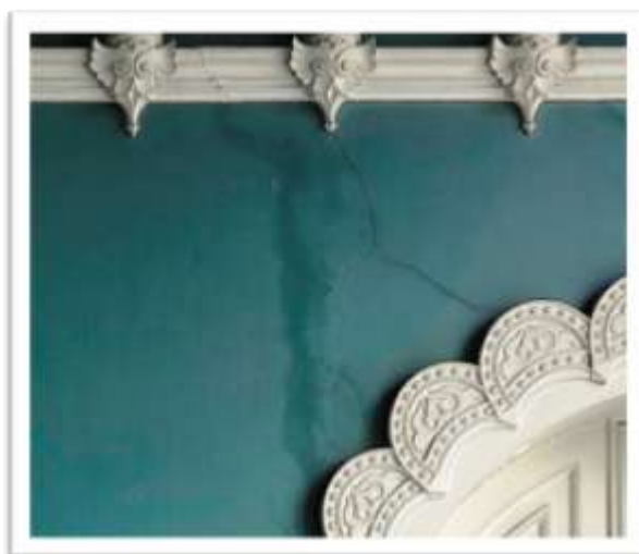
Figura 51 - Criptoflorescências nas Paredes Interiores
