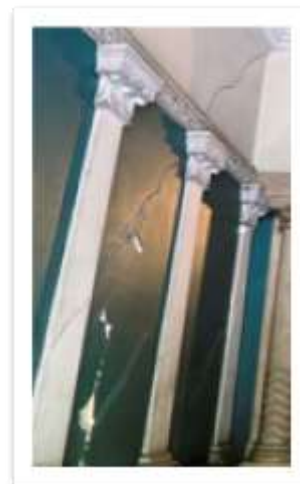
Figura 42 – Fendas Estruturais em Alvenaria de Tijolo – 45°
