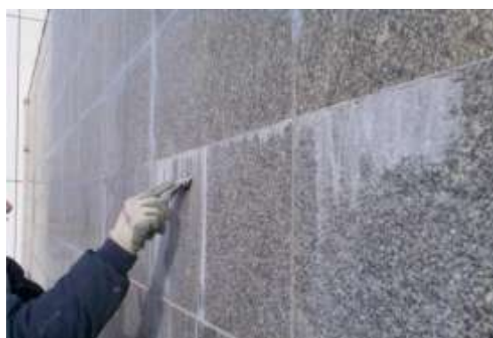
Figura 48 - Eflorescências em Cantarias [Fonte: Lahóz, 2016]
