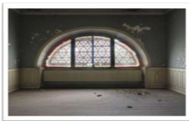
Figura 52 - Destacamento do Revestimento
