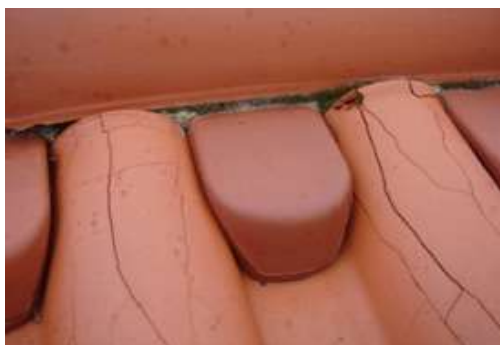
Figura 43 - Fendas em Telhas Cerâmicas
