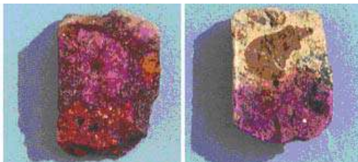
Figura 41 – Betão após ter sido pulverizado com fenolftaleína (Carbonatação do Betão)
