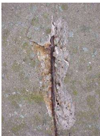
Figura 40 - Fissuração do Betão Armado
