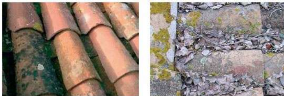
Figura 44 - Colonização Biológica e Lixos nas Telhas
