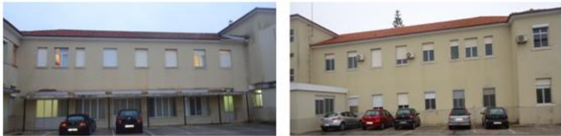
Figura 2.11 - Fachadas a Oeste (à esquerda: Piso 0 - UCSP Parede e Piso 1 - USF Kosmus; à direita: Piso 0 - UCSP Parede e Piso 1 - USF Artemisa). (arquivo de SF)
