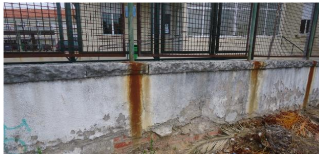
Figura 3.21 - Escorrimento no muro devido a corrosão pontual de peças metálicas. (arquivo de SF)
