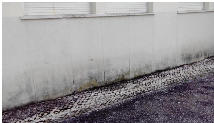
Figura 3.44 - Manchas de humidade devido à inexistência de um sistema adequado de rede de drenagem de águas pluviais. (arquivo de SF)
