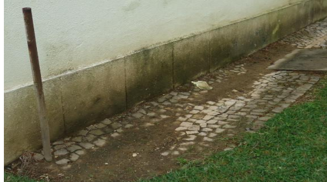
Figura 3.45 - Acumulação de sujidades na valeta. (arquivo de SF)
