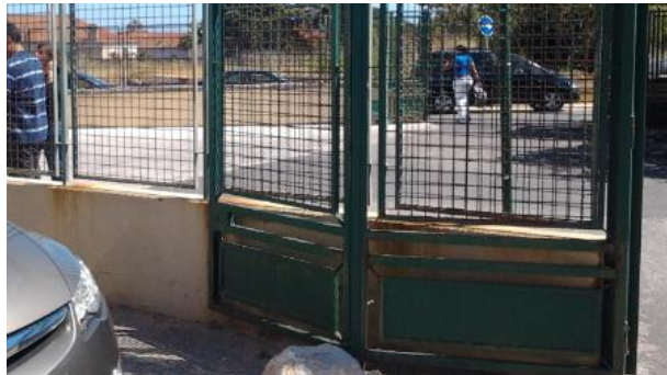
Figura 3.18 - Portão apresenta sinais de oxidação. (arquivo de SF)
