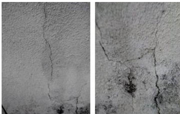
Figura 3.3 - Fissuração superficial. (arquivo de SF)
