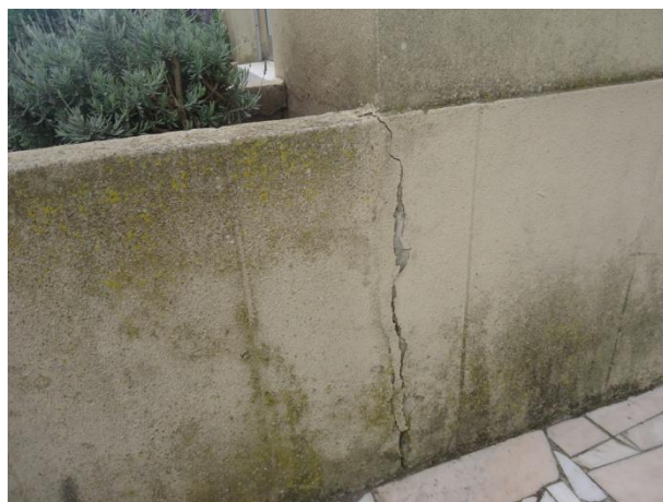
Figura 3.12 - Floreira com fissuras e colonização biológica. (arquivo de SF)
