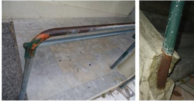
Figura 3.17 - Corrimão apresenta sinais de oxidação. (arquivo de SF)
