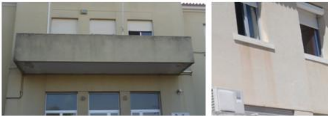
Figura 3.6 - Manchas de humidade e de escorrimento. (arquivo de SF)
