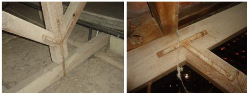
Figura 3.40 - Oxidação dos elementos de zinco. (arquivo de SF)
