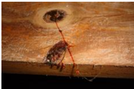
Figura 3.38 - Resinas à superfície da madeira. (arquivo de SF)
