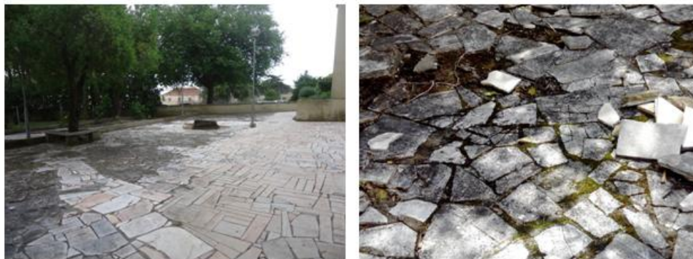
Figura 3.50 - Pavimento de mármore solto e deteriorado. (arquivo de SF)
