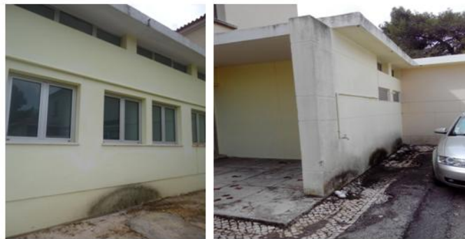
Figura 3.43 - Alteração da cor da fachada devido a salpicos de água provenientes da pingadeira. (arquivo de SF)
