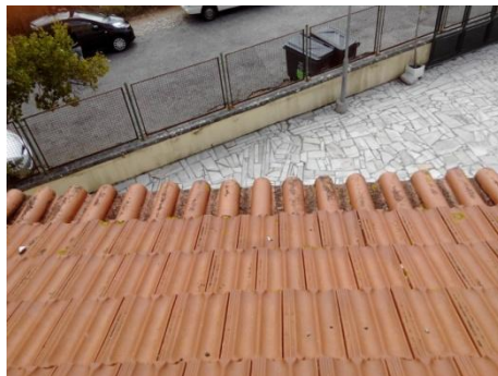
Figura 3.29 - Cobertura sem telhas de ventilação e passadeira. (arquivo de SF)
