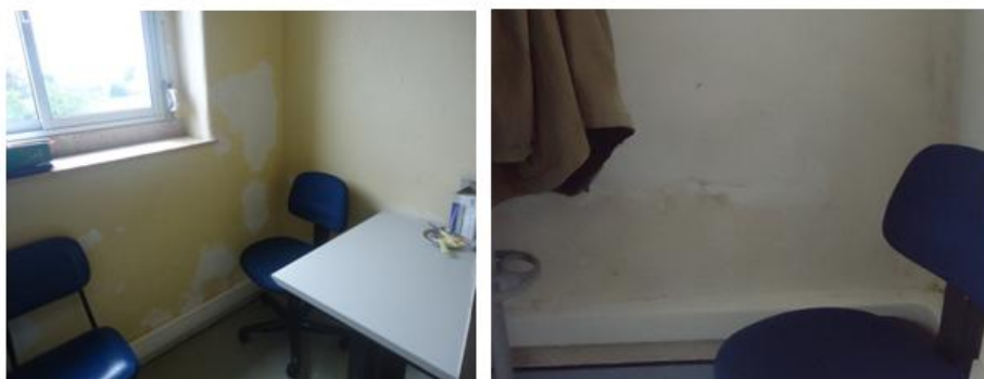
Figura 3.42 - Manchas de humidade interiores. (arquivo de SF)
