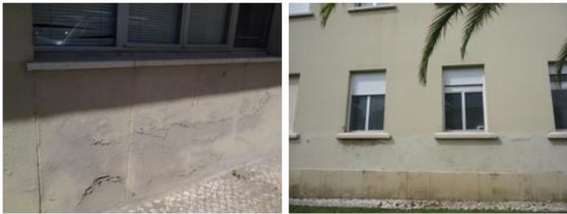
Figura 3.4 - Manchas de humidade junto ao solo nas fachadas do edifício. (arquivo de SF)
