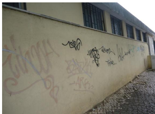
Figura 3.10 - Revestimento por pintura vandalizado com graffiti. (arquivo de SF)
