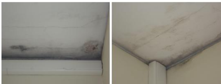
Figura 3.32 - Manchas de humidade no interior do edifício. (arquivo de SF)
