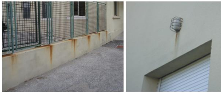
Figura 3.20 - Escorrimento na fachada devido a corrosão pontual de peças metálicas. (arquivo de SF)
