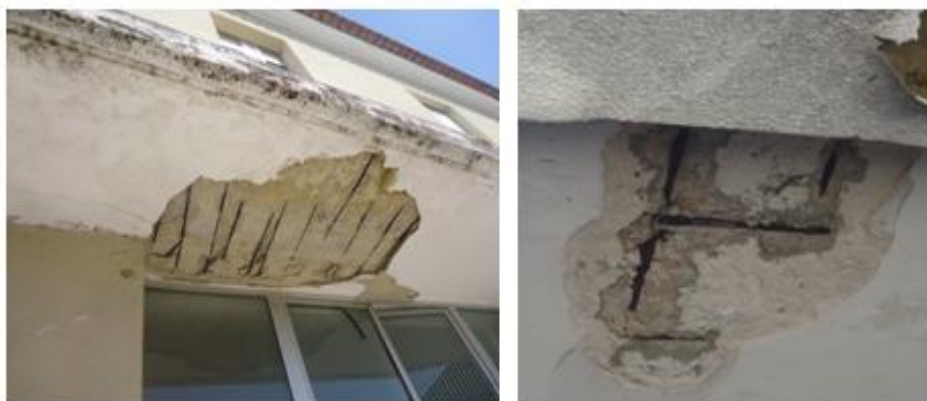
Figura 3.14 - Delaminação do betão nas palas. (arquivo de SF)
