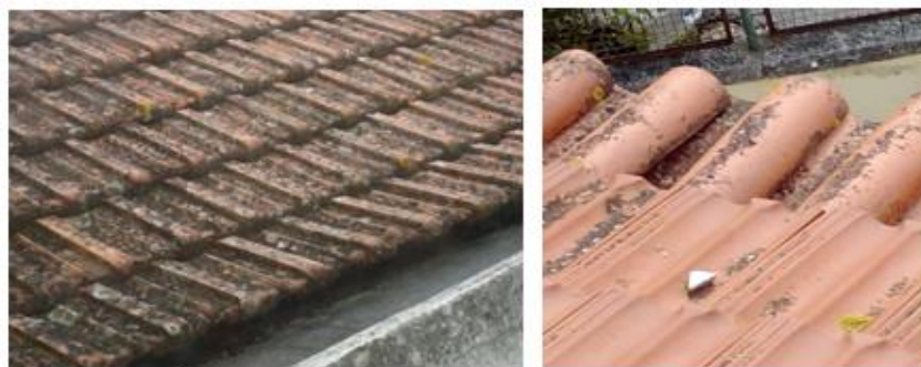
Figura 3.30 - Colonização biológica nas telhas. (arquivo de SF)
