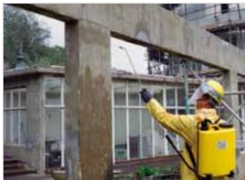
Figura 4.13 - Proteção inibidora de corrosão. (I14)
