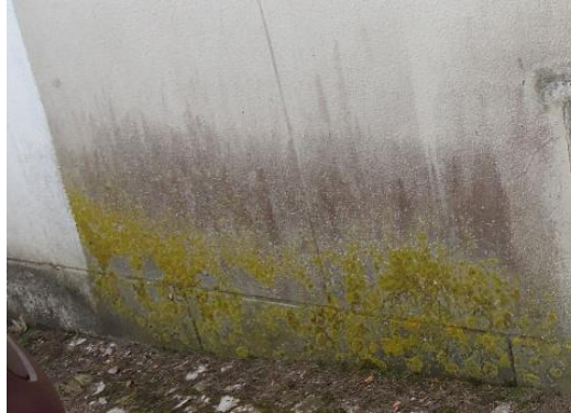
Figura 3.9 - Fachada com desenvolvimento de vegetação parasitária e fungos. (arquivo de SF)
