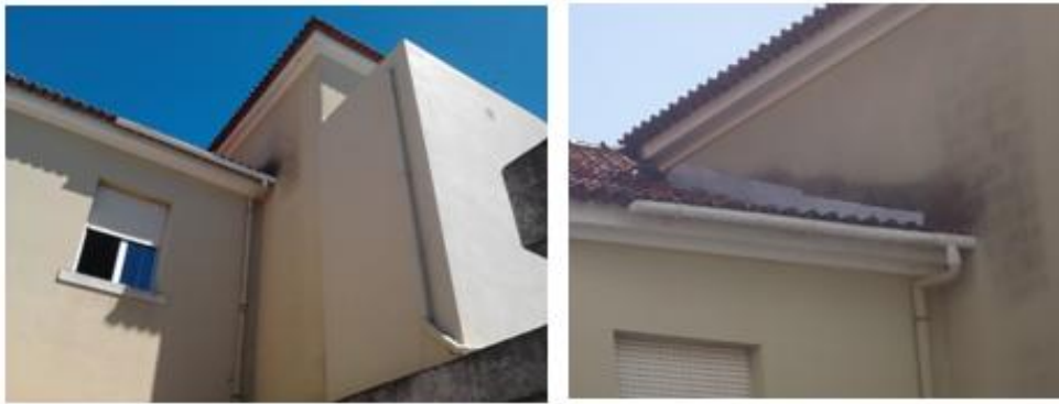
Figura 3.31 - Manchas de humidade na fachada junto à caleira. (arquivo de SF)
