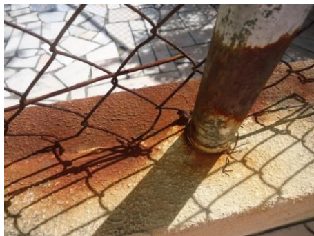
Figura 3.19 - Pormenor da corrosão das peças metálicas. (arquivo de SF)
