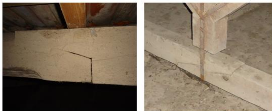
Figura 3.37 - Rotura mecânica. (arquivo de SF)
