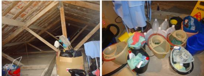
Figura 3.39 - Acumulação de material na cobertura. (arquivo de SF)
