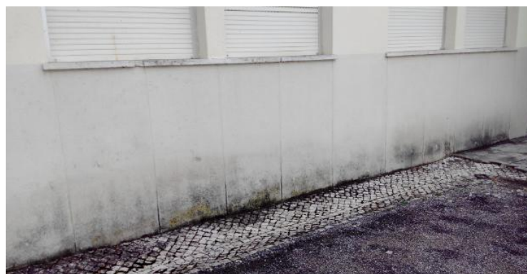
Figura 3.5 - Manchas de humidade junto ao solo na fachada do edifício. (arquivo de SF)
