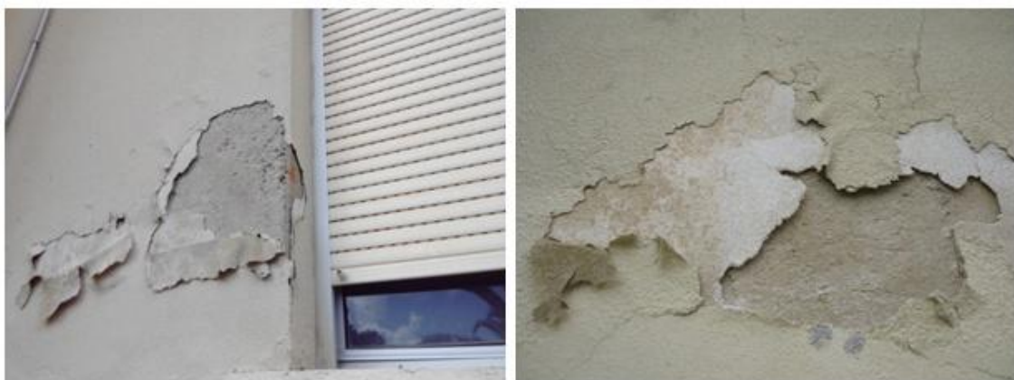
Figura 3.1 - Destacamento do reboco. (arquivo de SF)
