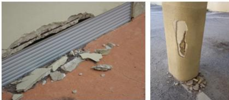
Figura 3.13 - Delaminação do betão na viga e no pilar. (arquivo de SF)
