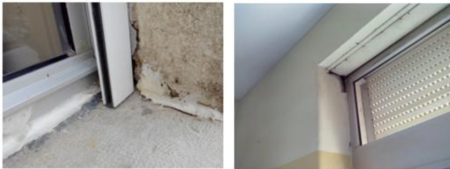
Figura 3.23 - Deficiente execução das ligações da caixilharia com as paredes. (arquivo de SF)
