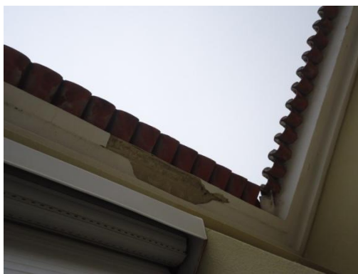
Figura 3.33 - Degradação da cimalha. (arquivo de SF)
