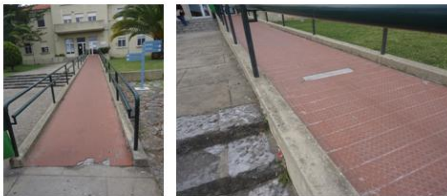
Figura 3.55 - Revestimento cerâmico da rampa com pontuais elementos partidos ou em falta. (arquivo de SF)
