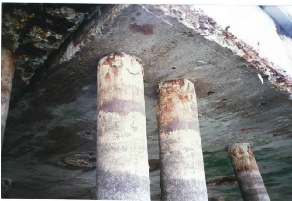
foto 2 – Pormenor do fuste das estacas e juntas de dilatação das lajes da plataforma do cais
