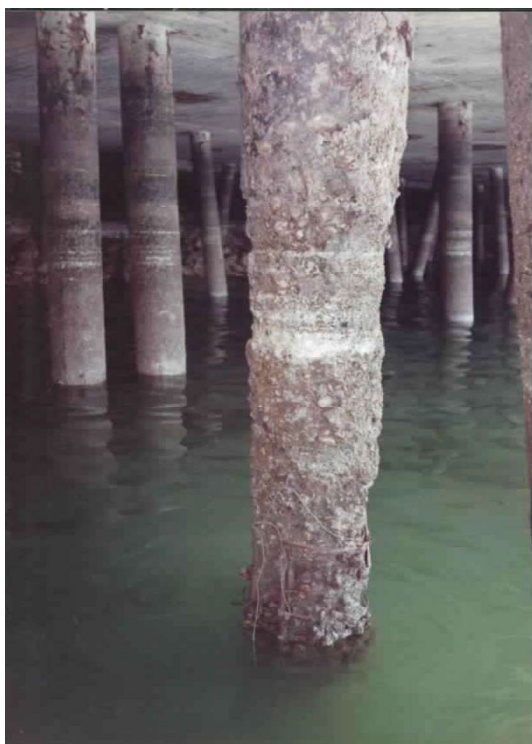
foto 7 – Pormenor estacas deterioradas
