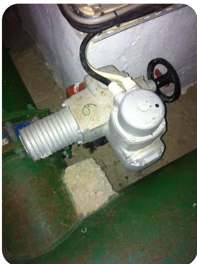
Figura 28 - Válvula motorizada 4 da estação de Colaride
