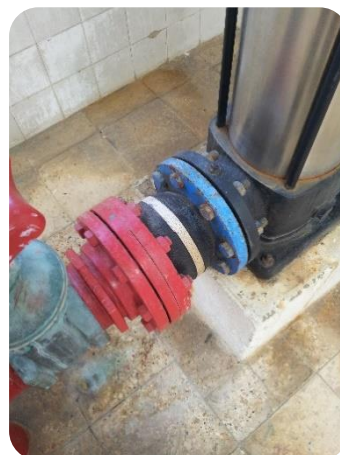
Figura 11 - Acoplamento entre a eletrobomba 1 e a válvula manual da estação Quinta Grande.
