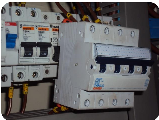
Figura 39 - Incorreta instalação dos disjuntores no quadro elétrico principal.
