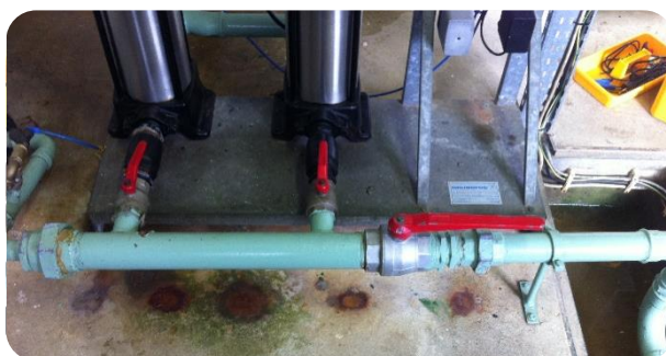
Figura 13 - Pormenor das válvulas globo da estação de Olelas.
