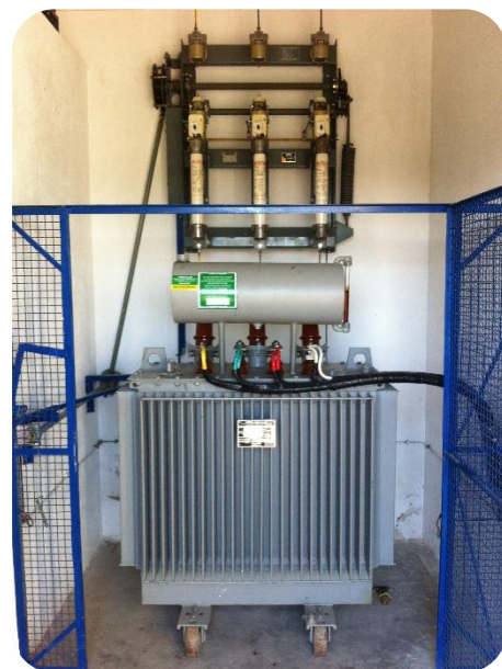
Figura 43 - Transformador e fusíveis da estação de Venda Seca.
