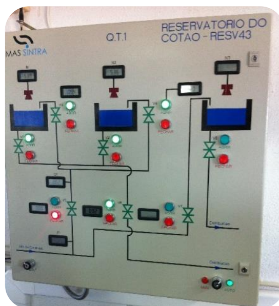
Figura 26 - Quadro elétrico principal da estação de Cotão.
