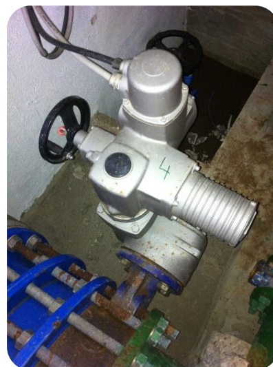
Figura 29 - Válvula motorizada 4 da estação de Colaride
