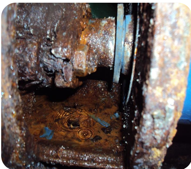
Figura 41 - Pormenor da eletrobomba na estação de Massamá Norte.
