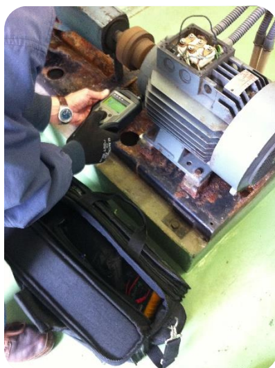
Figura 30 - Recolha de vibrações horizontais na eletrobomba 2 na estação de Ouressa.
