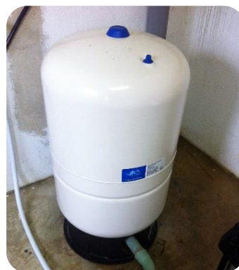
Figura 15 - Balão hidropressor da estação de Olelas.
