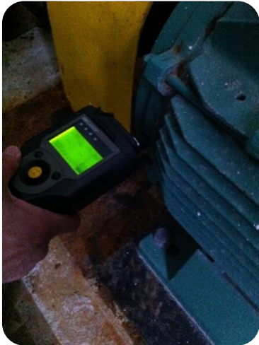
Figura 19 - Recolha da velocidade de vibrações horizontais junto ao acoplamento do motor.
