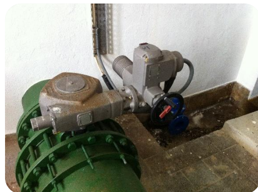
Figura 21 - Válvula motorizada na estação de Gémeos.
