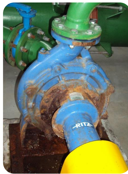
Figura 40 - Eletrobomba da estação de Massamá Norte.
