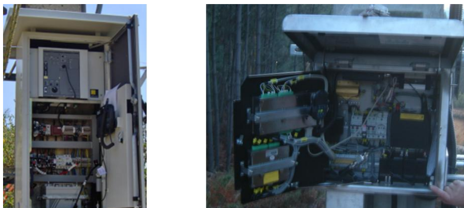
Figura 4.7 – Unidade Remota de Rede (URR)
