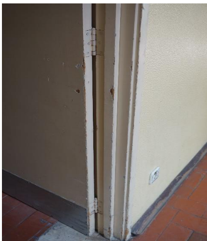
Figura nº 3 – Deterioração da Porta e do aro em madeira
