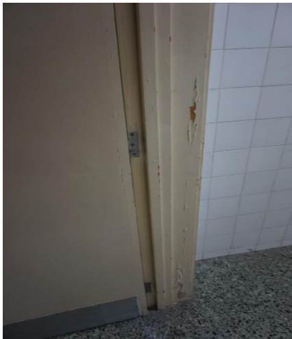
Figura nº 1 – Deterioração da Porta e do aro em madeira
