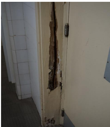
Figura nº 7 – Deterioração da Porta e do aro em madeira
