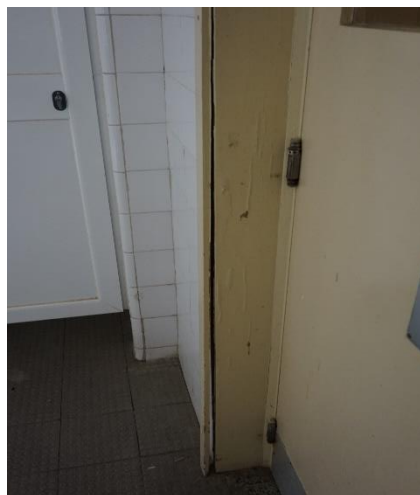
Figura nº 4 – Deterioração da Porta e do aro em madeira
