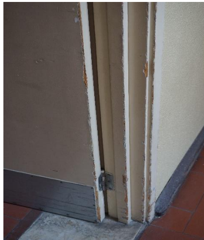
Figura nº 2 – Deterioração da Porta e do aro em madeira
