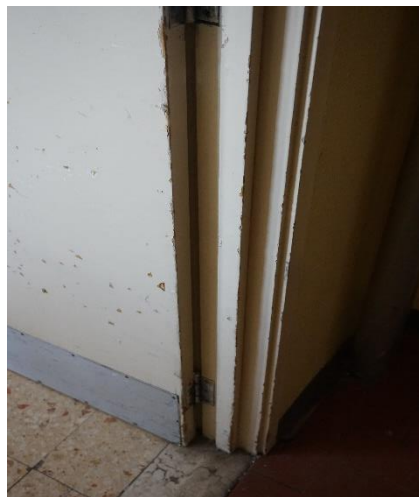
Figura nº 6 – Deterioração da Porta e do aro em madeira
