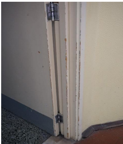
Figura nº 5 – Deterioração da Porta e do aro em madeira
