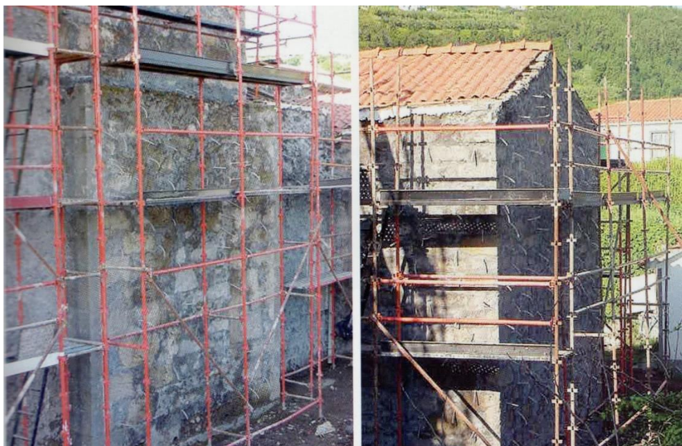
Figura 3.10 Injecção em paredes de alvenaria, adaptado de (Paisana dos Santos Lopes et al., 2008)
