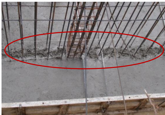
Figura 3.13 - Superfície rugosa na zona das armaduras do muro
