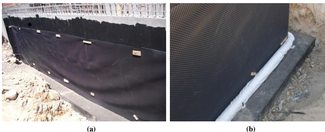
Figura 3.19 - Colocação da membrana de nódulos (a) e colocação do tubo geodreno (b)
