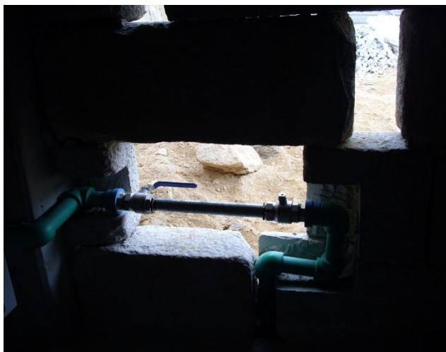
Figura 3.50 - Válvula de corte da rede de água pública
