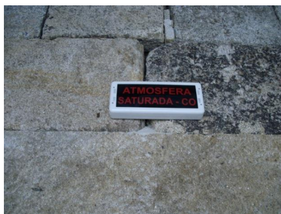
Figura 3.58 - Dispositivo do sistema de deteção de monóxido de carbono
