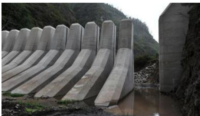
Figura 51 - Açude localizado na ribeira de Santa Luzia (Funchal)
