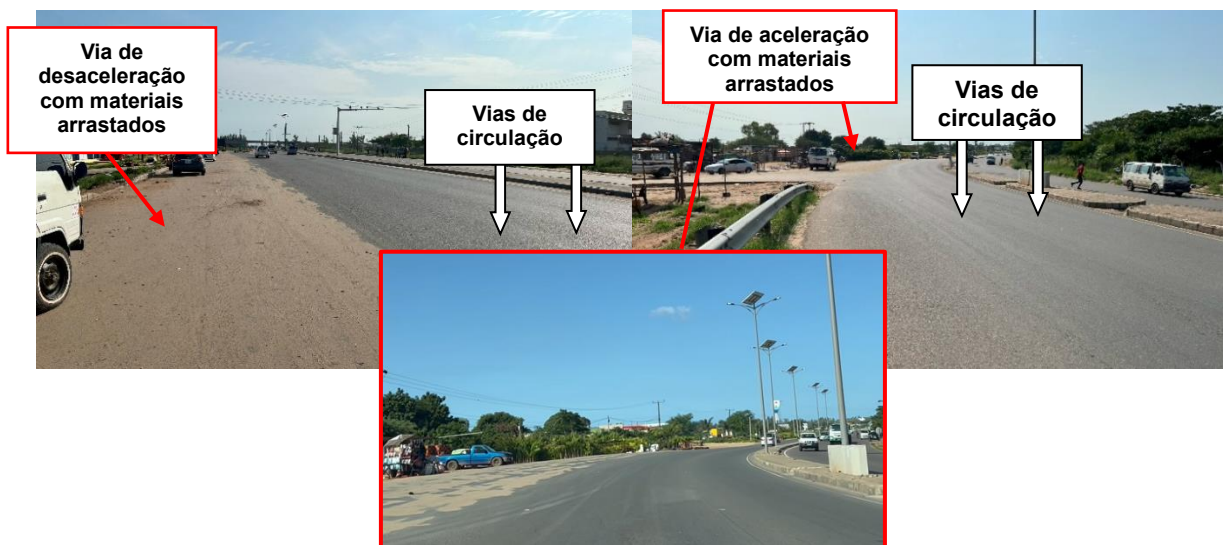
Figura 5-42 Materiais arrastados para a faixa de rodagem.
