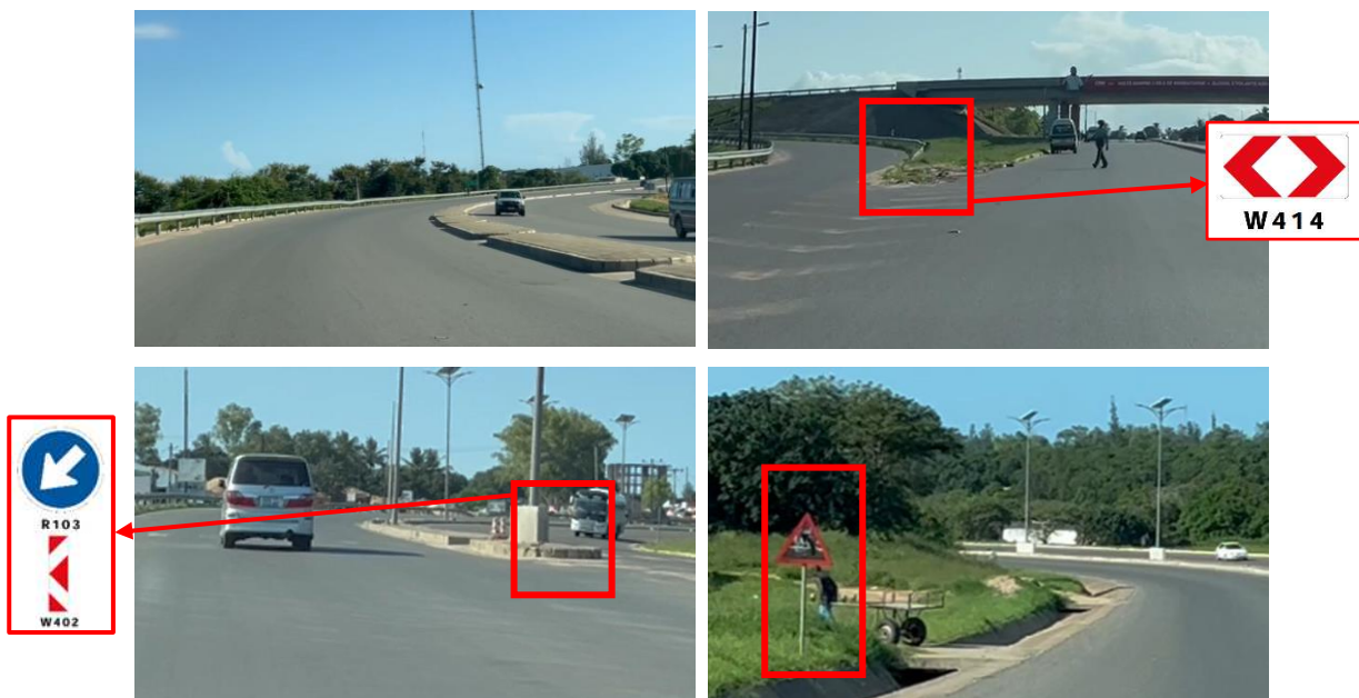
Figura 5-45 Problemas de sinalização.
