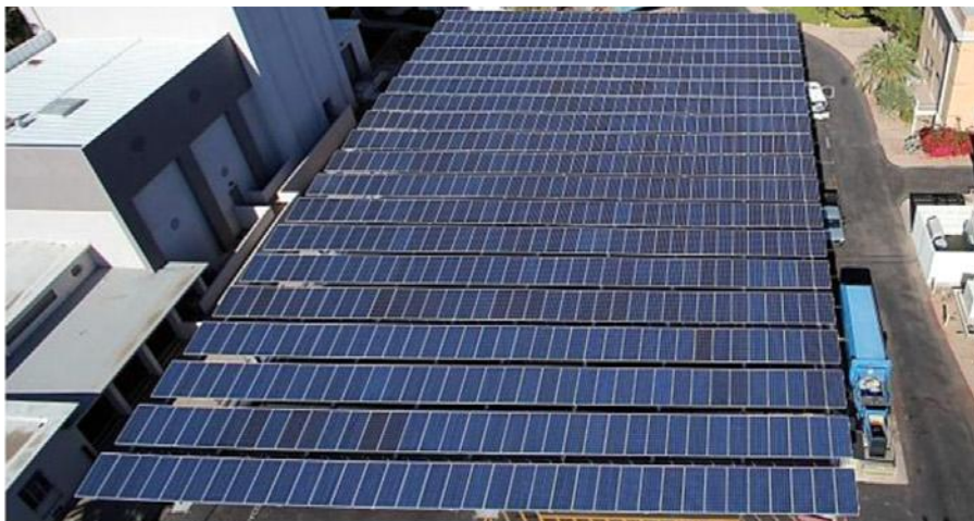
Figura 9 - Estrutura carport solar implementado em parque de estacionamento totalmente coberto
