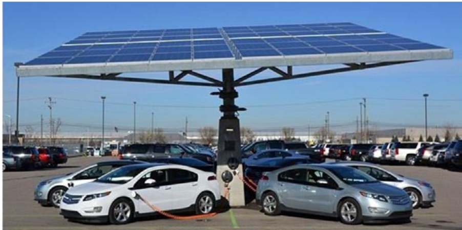
Figura 10 - Estrutura carport tipo árvore solar implementado em parque de estacionamento
