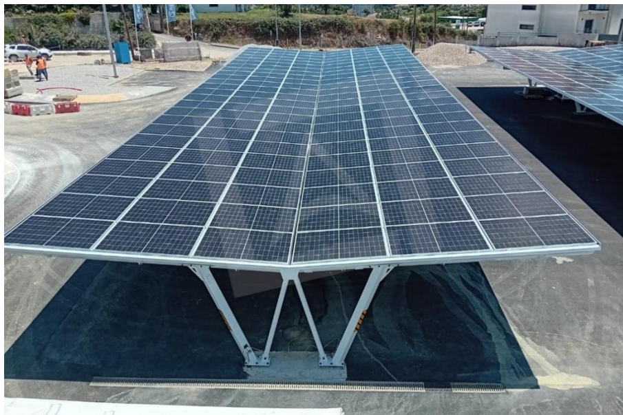
Figura 18 - Instalação de um sistema Carport Solar, executado por Valente e Lopes Group, no parque de estacionamento do estabelecimento do Continente em Proença-a-Nova
