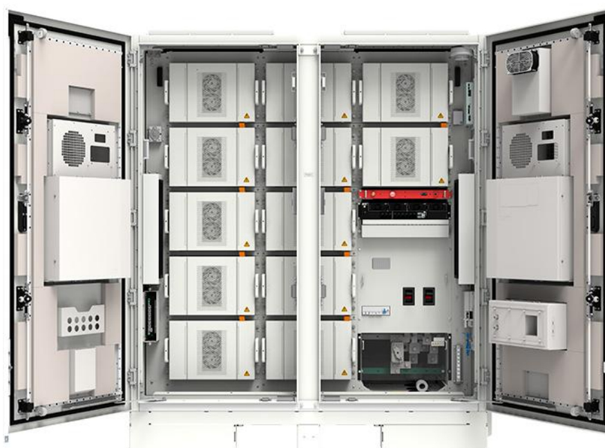
Figura 21 - Interior do sistema de armazenamento de energia, modelo Huawei Luna2000-200kWh-2h1-02
