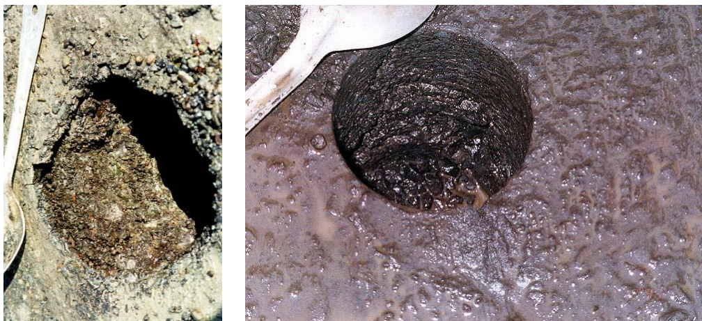
Figura 2.9 – Desagregação com início na base das camadas betuminosas ( http://pavementinteractive.org )
