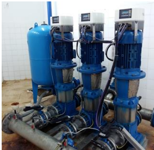
Figura 23 - Bombas instaladas no reservatório de Vila Nova da Rainha
