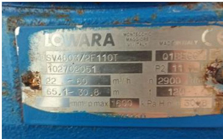
Figura 24 – Características das bombas instaladas no reservatório
