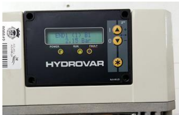
Figura 39 – Pressão de serviço na bomba
