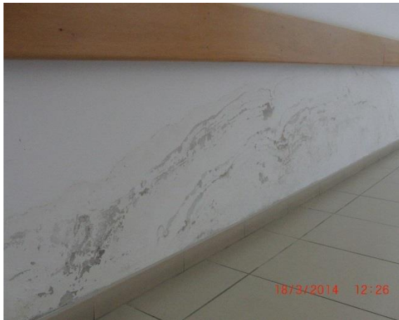
Figura 43 - Humidades Ascensionais nas Paredes, RL
