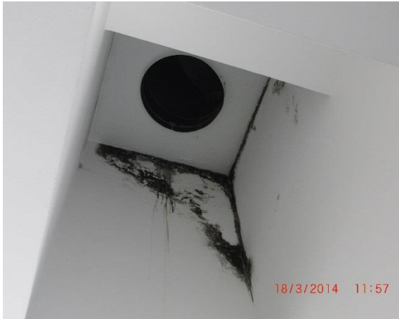
Figura 49 - Infiltrações em Conduto, RL
