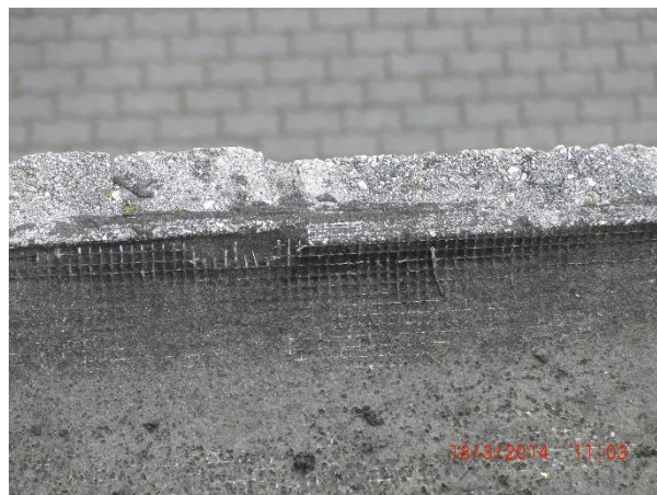
Figura 18 - Desgaste da tela asfáltica
