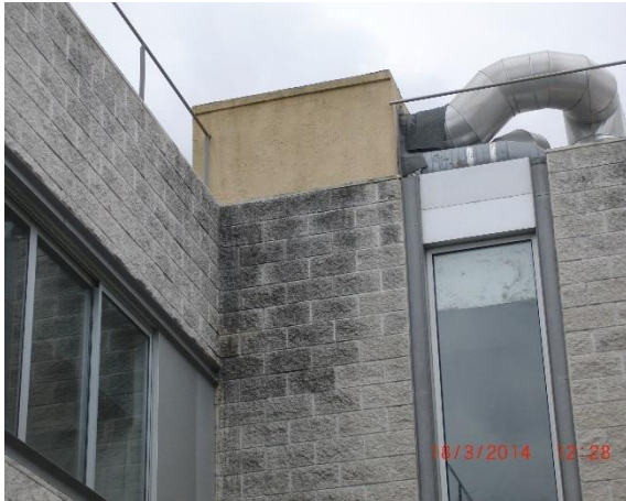
Figura 27 - Escorrências na Fachada, RL
