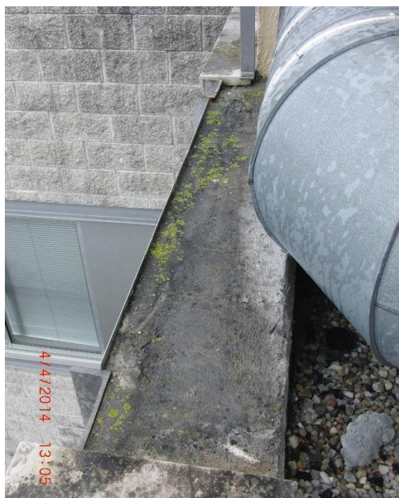
Figura 37 - Inexistência de Pedra de Capeamento, RL
