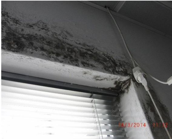
Figura 45 - Humidades por Condensação nas Paredes, RL
