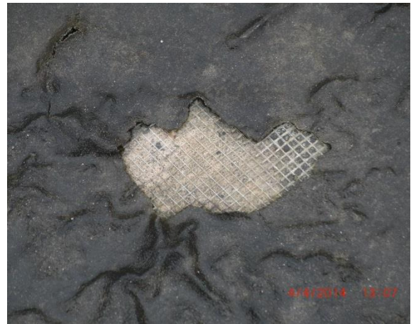
Figura 42 - Armadura de Fibra de Vidro Exposta, RL
