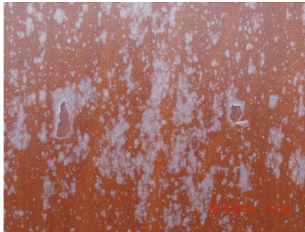
Figura 11 - Degradação painéis fenólicos
