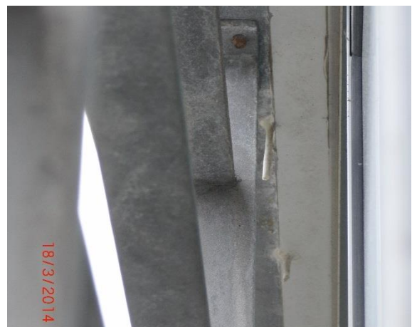
Figura 30 - Infiltrações pelas Guardas dos Vãos, RL
