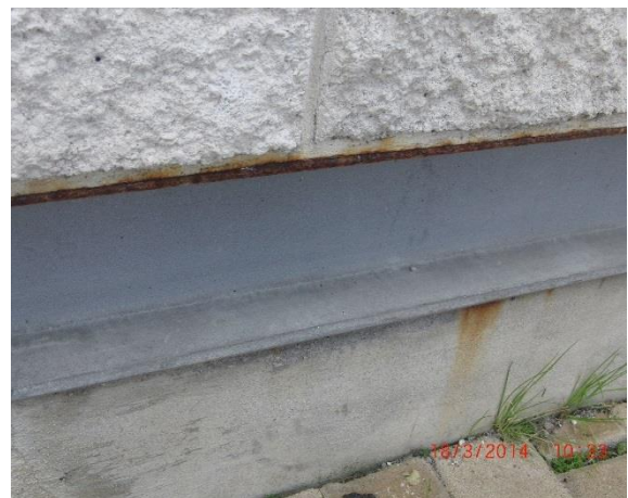
Figura 24 - Corrosão nos Perfis da Fachada, RL
