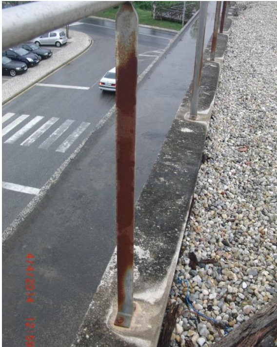
Figura 33 - Corrosão nas Guardas da Cobertura, RL
