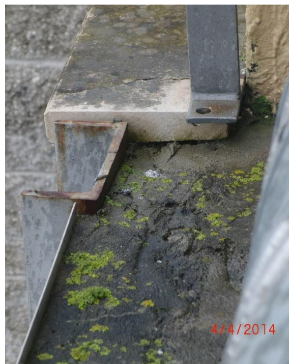
Figura 38 – Aproximação (Ocorrem Infiltrações), RL
