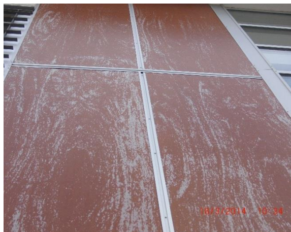
Figura 25 - Painéis Fenólicos Degradados, RL
