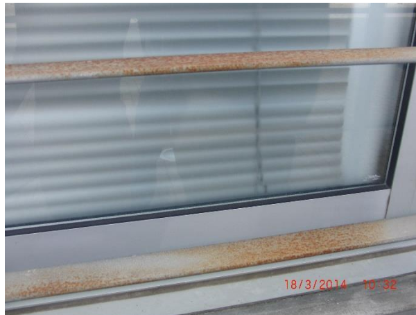
Figura 12 - Corrosão nas guardas metálicas da fachada
