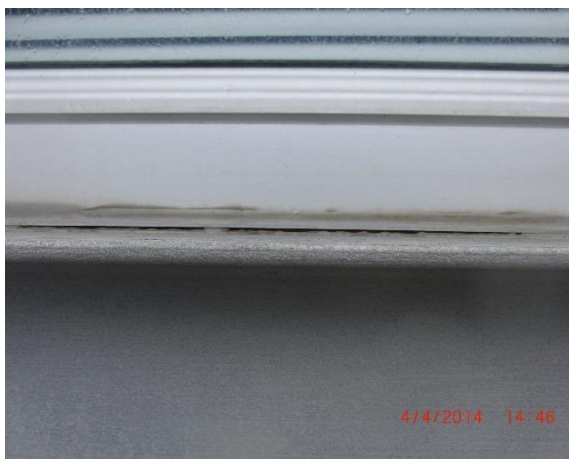
Figura 29 - Infiltrações na Caixilharia dos Vãos, RL
