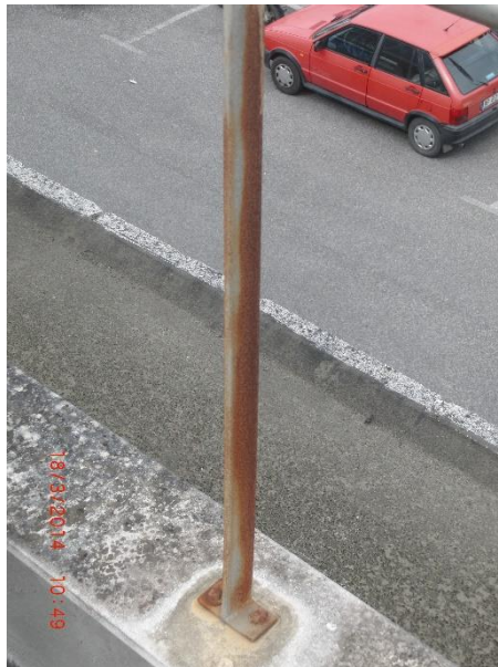
Figura 17 - Corrosão nas guardas metálicas da cobertura
