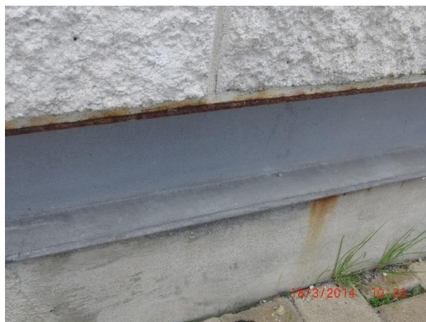
Figura 13 -Corrosão nos perfis metálicos
