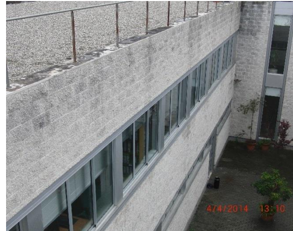
Figura 28 - Deposição de Sujidade na Fachada, RL
