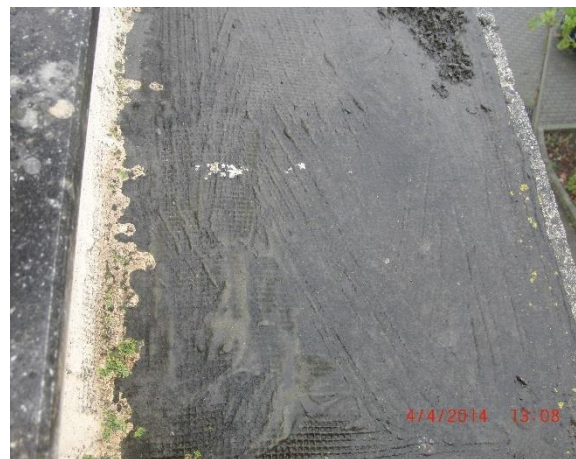
Figura 40 - Acumulação de Água na Tela, RL
