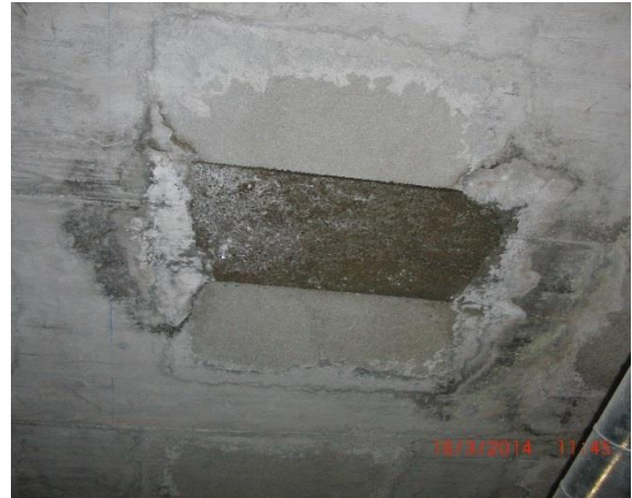
Figura 50 - Infiltrações Acima do Teto Falso, RL
