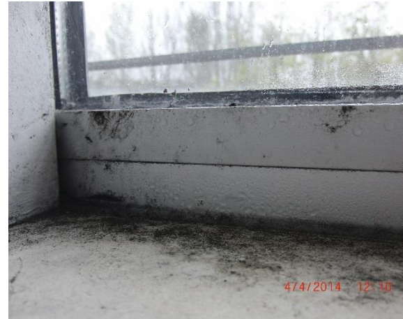
Figura 46 - Condensação na Caixilharia dos Vãos, RL
