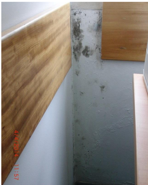
Figura 47 – Eflorescências nas Paredes, RL
