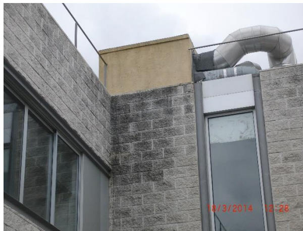
Figura 9 - Escorrências na fachada
