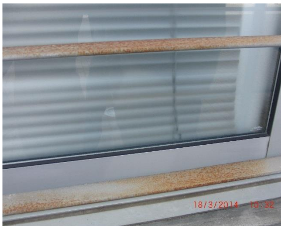
Figura 23 - Corrosão nas Guardas dos Vãos, RL
