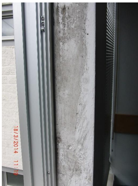
Figura 21 - Humidades de condensação
