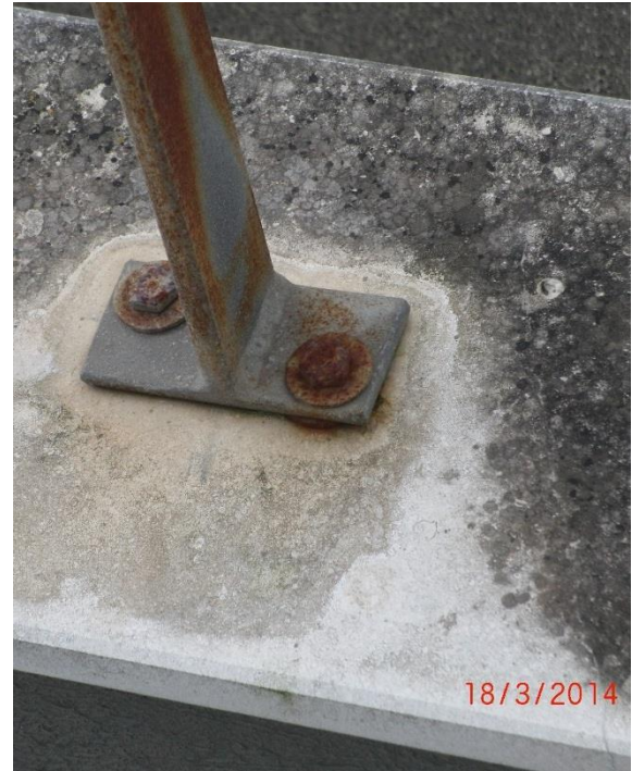
Figura 34 - Corrosão nas Ligações ao Capeamento, RL
