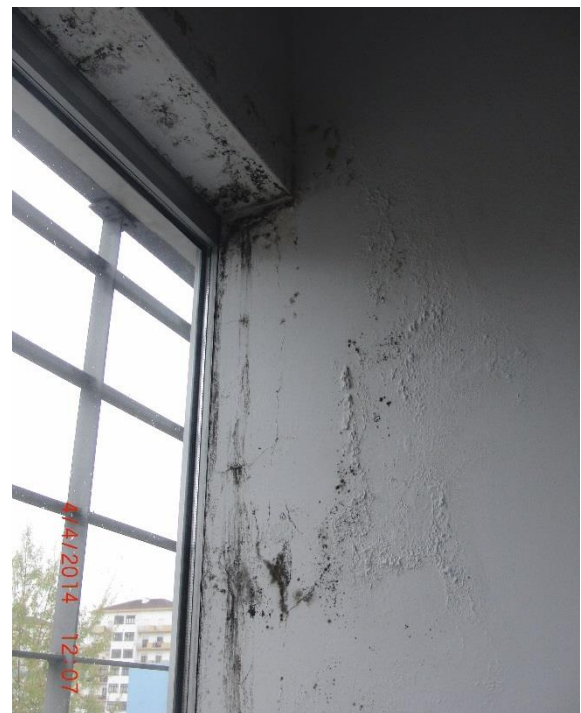
Figura 48 - Criptoflorescências nas Paredes, RL
