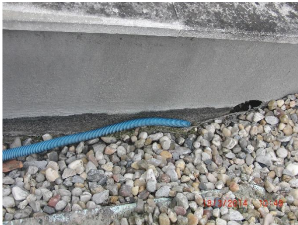
Figura 14 - Obstrução nas caeiras 1
