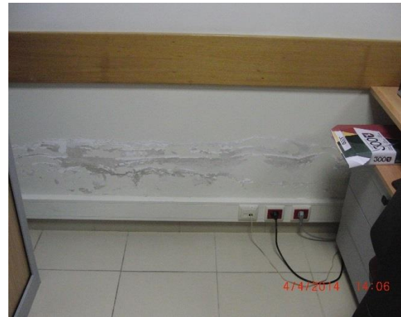
Figura 44 - Destacamento do Revestimento, RL
