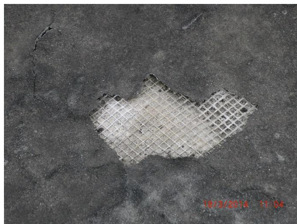
Figura 19 - Degradação da tela asfáltica
