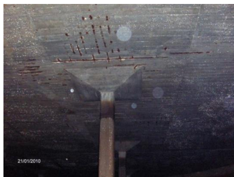
Fig. 73 – Armadura à vista e corrosão
