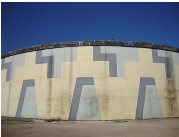
Fig. 11 - Reservatório de Santo António dos Cavaleiros, inexistência de tubos de queda para águas pluviais
