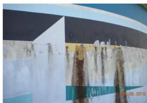
Fig. 48 - Parede exterior com humidade
