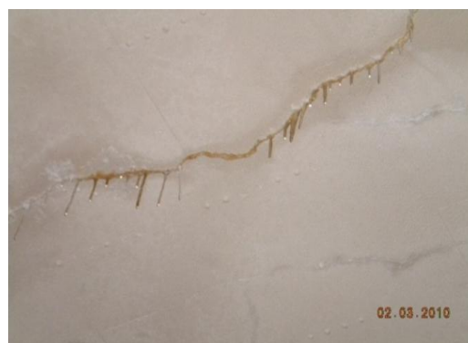
Fig. 19 - Laje de cobertura com formação de estalactites
