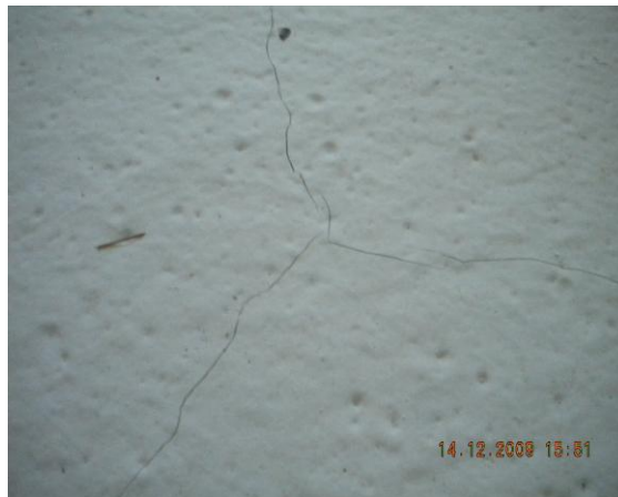
Fig. 44 - Laje de fundo fendilhada
