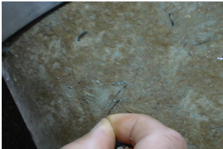
Fig. 13 – Tubagem de fibrocimento com partículas de amianto.
