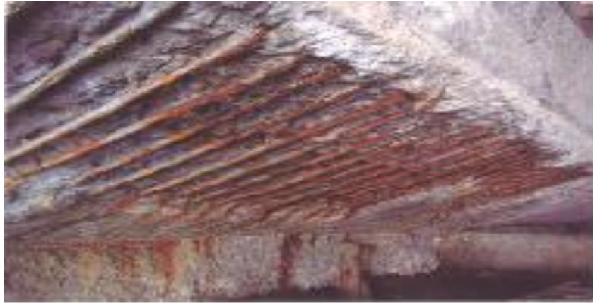
Fig. 10 – Corrosão no betão armado
