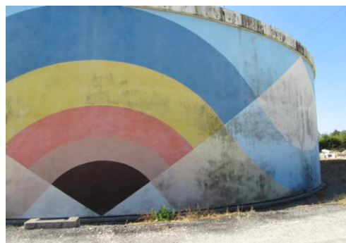
Fig. 50 - Parede com sujidade
