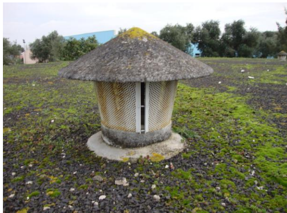
Fig. 55 - Grelha de ventilação
