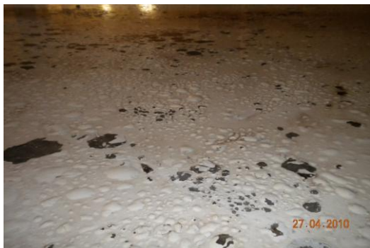
Fig. 45 - Destacamento e formação de bolhas
