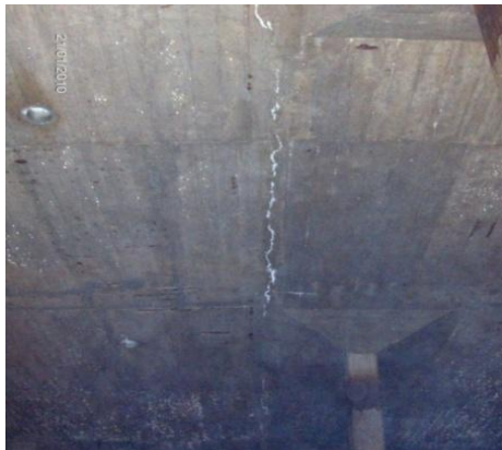
Fig. 72 – Fissuração no tecto
