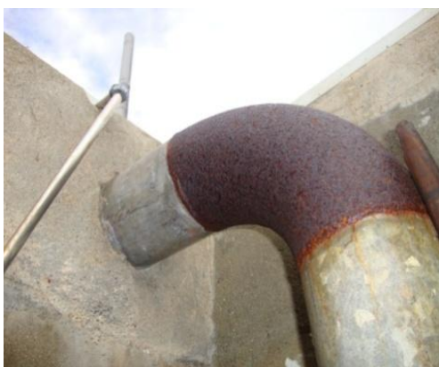
Fig. 14 – Oxidação de curva em inox
