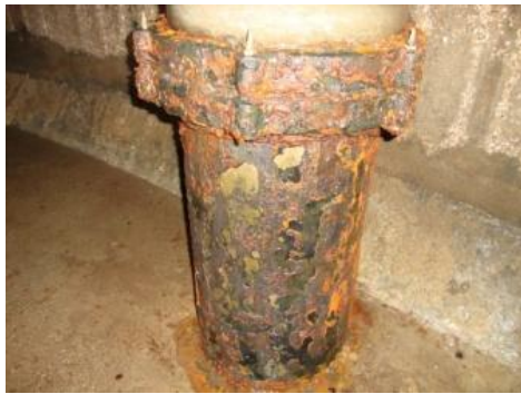
Fig. 51 - Elemento metálico ferrosos
