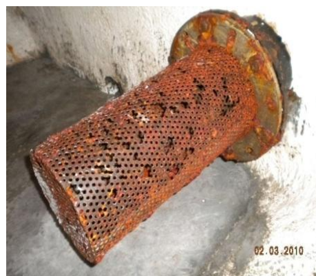
Fig. 15 – Oxidação de filtro em inox
