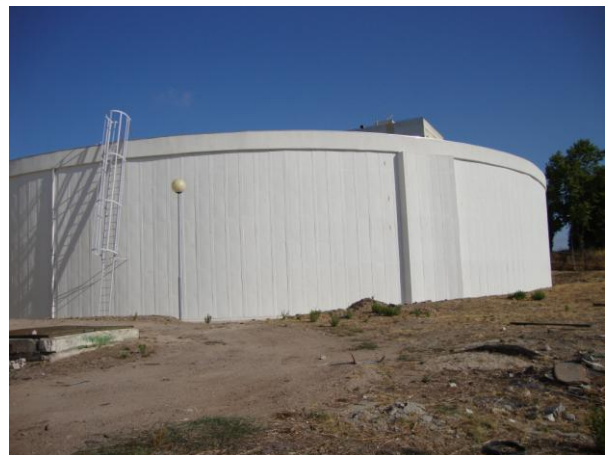
Fig. 12 - Reservatório de Sto. António dos Cavaleiros, com tubos de queda para águas pluviais
