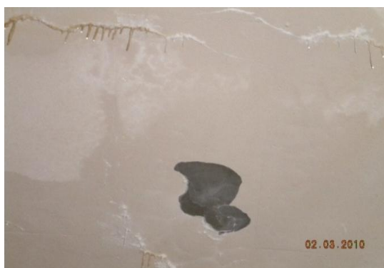
Fig. 18 - Laje de cobertura com formação de estalactites
