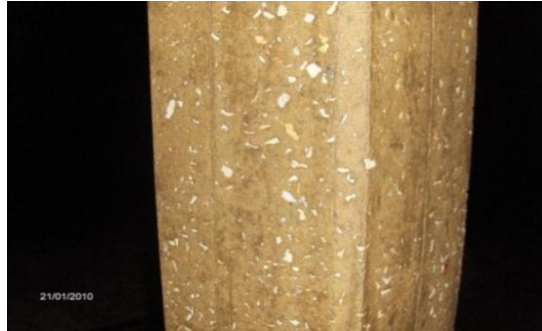
Fig. 71 – Erosão nos pilares
