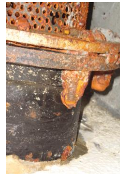
Fig. 52 - Elemento metálico ferrosos
