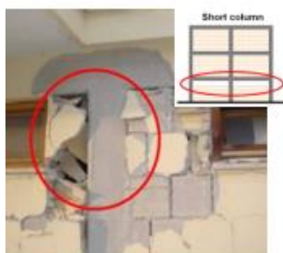
Figura 6.4-Rotura por corte de um pilar junto a uma abertura-mecanismo tipo pilar curto (adaptado de H. Varum et al.)
