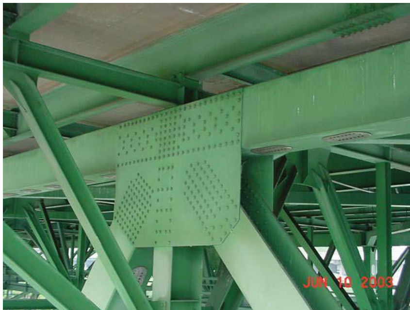
Figura 14 - Um nó típico da ponte I-35W constituído por placas gusset . [6]
