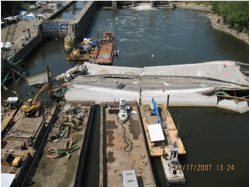
Figura 19 – Secção central da ponte I-35W após o colapso. [5]
