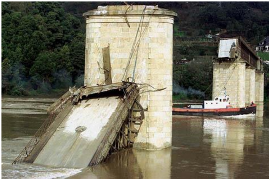
Figura 38 - Ponte Hintze Ribeiro no dia do colapso
