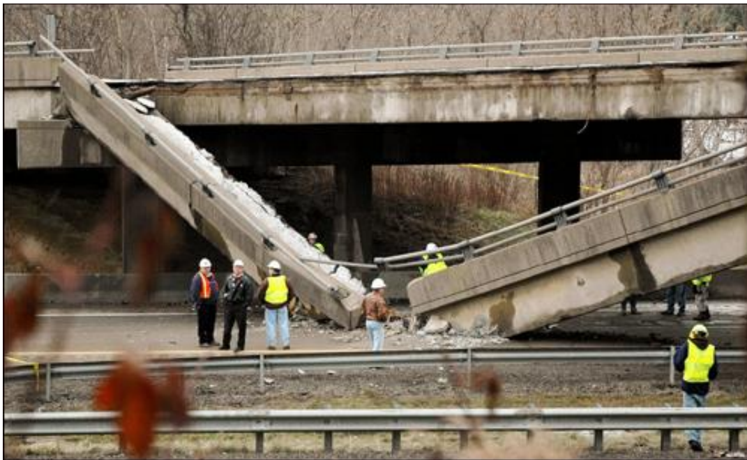
Figura 3 – Colapso durante a construção da ponte I-70 em Denver, Colorado (2004).
