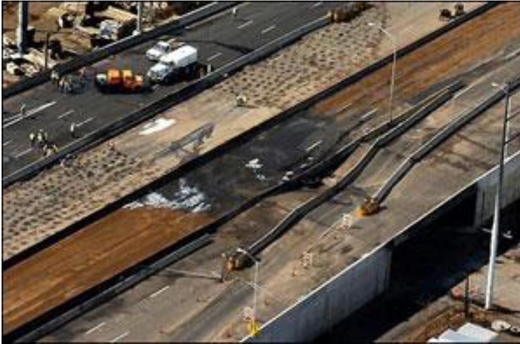
Figura 5 – Incêndio na ponte I-95 na Pennsylvania (2004)
