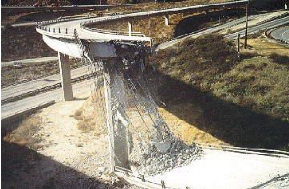
Figura 6 - Colapso da ponte I-5 em Los Angeles (Califórnia) causado por um sismo de magnitude 6.7 na escala de Richter (1994). [ http://www.fhwa.dot.gov ]
