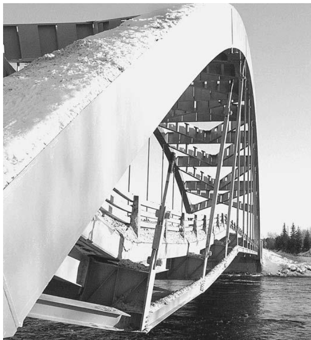
Figura 35 – Colapso parcial da ponte. [10]
