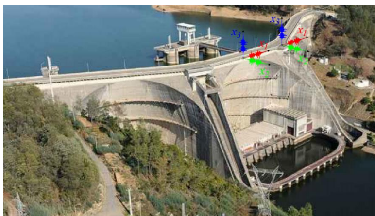
Figura 5.15 – Representação da barragem da Aguieira com os pontos de medição de acelerações (galeria superior). Num 1º ensaio foi colocado um acelerómetro triaxial no topo da abóbada central e num 2º ensaio o mesmo acelerómetro foi colocado no topo do contraforte esquerdo.
