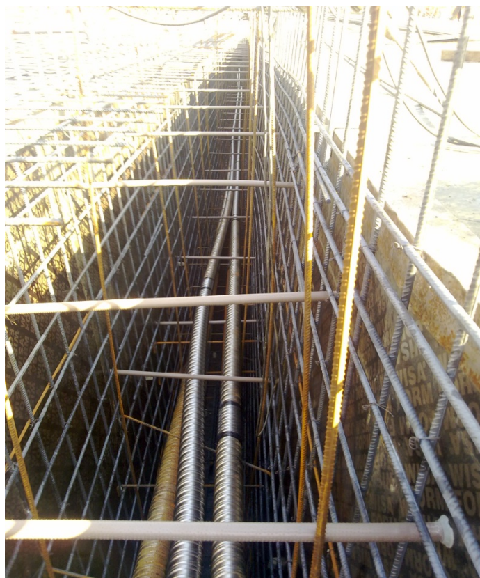
Fotografia 3.13 – Pormenor traçado dos cabos
