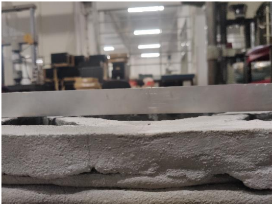
Figura 4.33 - Desnível da regularização do Modelo 3
