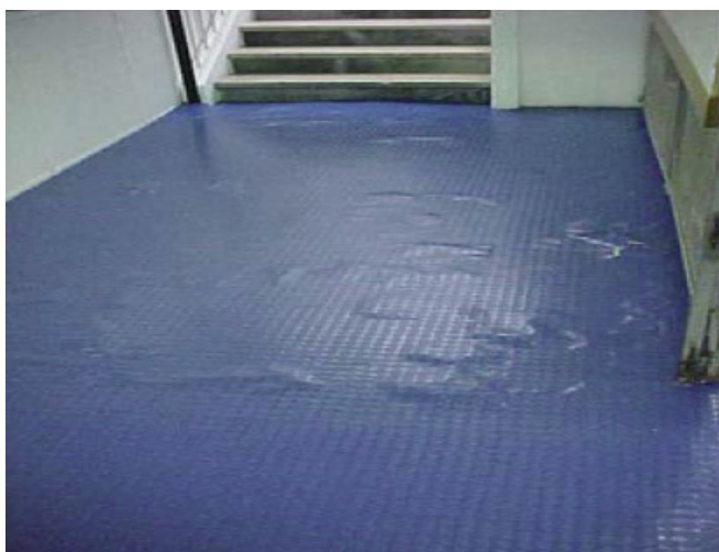
Figura 11 – Exemplo de bolhas no pavimento independentemente do tipo de suporte [12]
