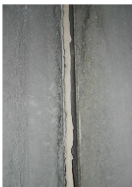
Figura 14 – Junta onde foi excedida a capacidade de movimento do vedante (12)
