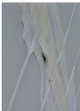
Figura 15 – Junta com pouca profundidade, que limita a sua capacidade de movimento (12)
