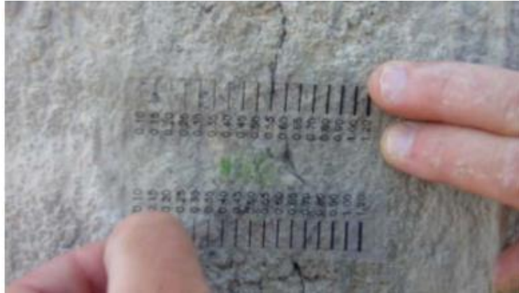
Figura 6.2 – Medição da abertura de fendas
