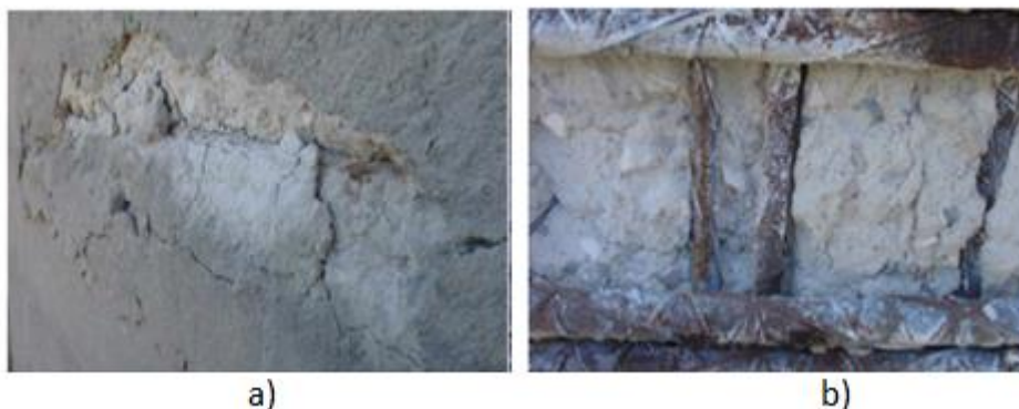
Figura 6.1 – a) Betão delaminado na junta; b) Armaduras emendadas já corroídas
