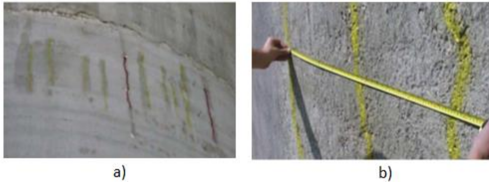
Figura 6.6 – a) Distribuição das fendas verticais; b) afastamento entre as fendas-tipo
