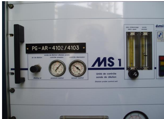
Figura 18 – Analisador da chaminé (2 e 3)
