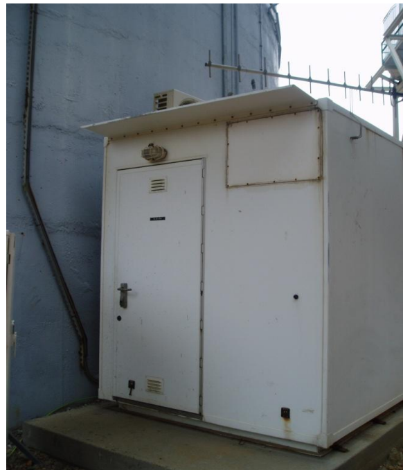
Figura 16 – Armário do analisador da chaminé
