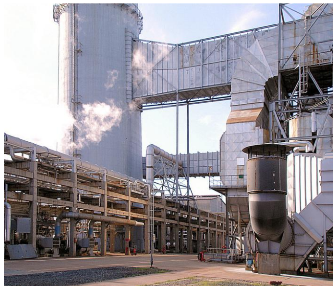
Figura 3 – Vista da conduta de gases das unidades da Fabricação I para chaminé
