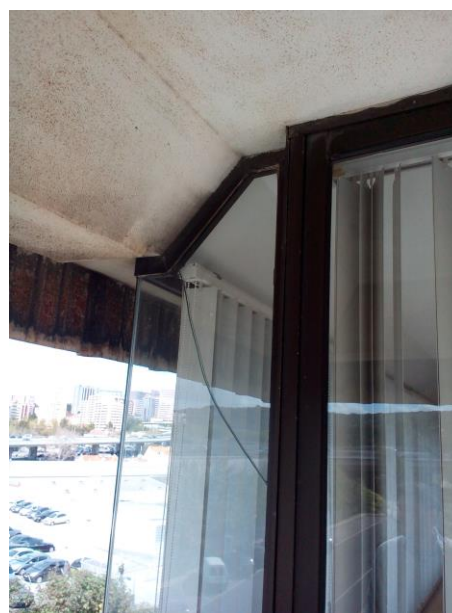
Figura 34 – Vidro de canto quebrado
