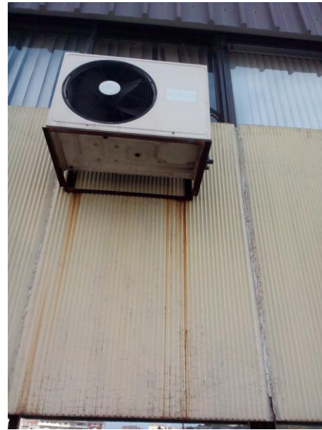
Figura 38 – Corrosão da fixação da unidade exterior de ar condicionado
