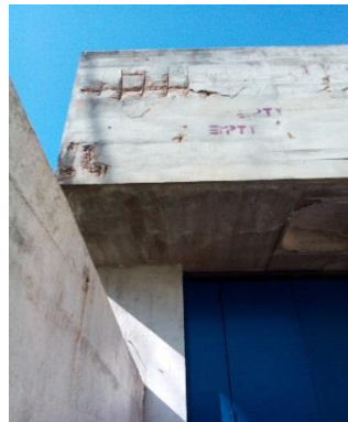
Figura 2 – Degradação do betão na platibanda
