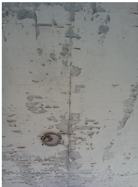
Figura 8 – Destacamento de pintura
