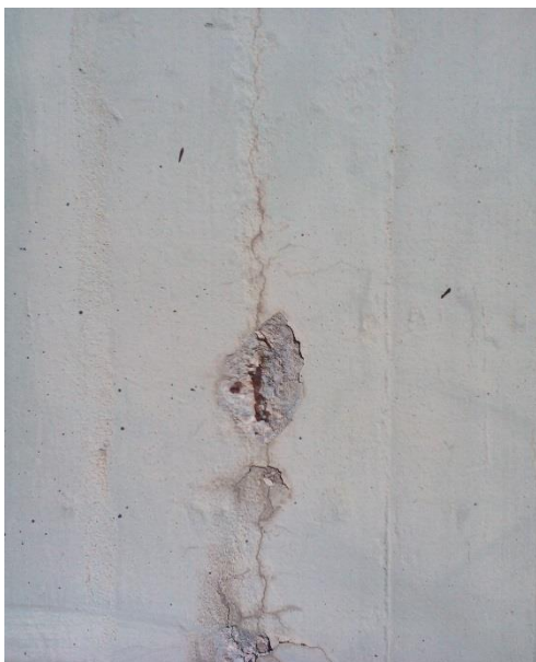
Figura 5 – fissuração do betão n parede do edifício
