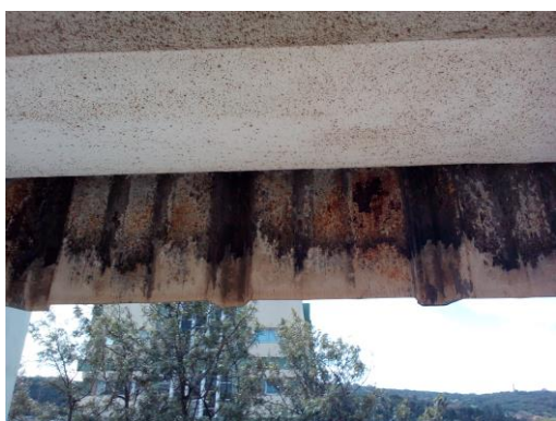
Figura 33 – Corrosão das chapas de cobertura
