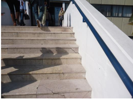
Figura 29 – Desgaste dos degraus da entrada principal
