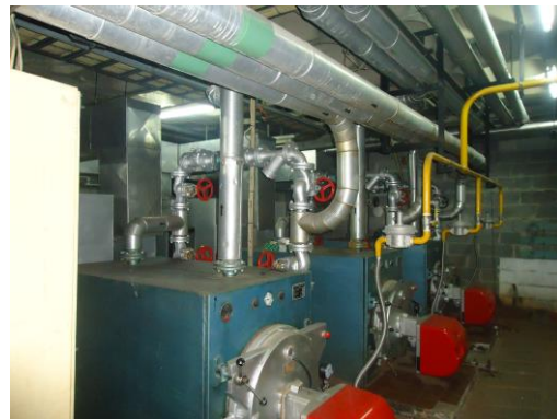
Figura 26 - Bombas válvulas e tubagens do sistema de aquecimento
