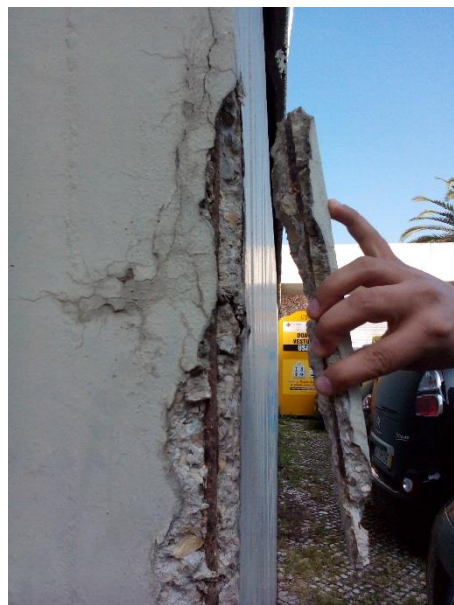
Figura 6 – Destacamento do betão na parede da cave
