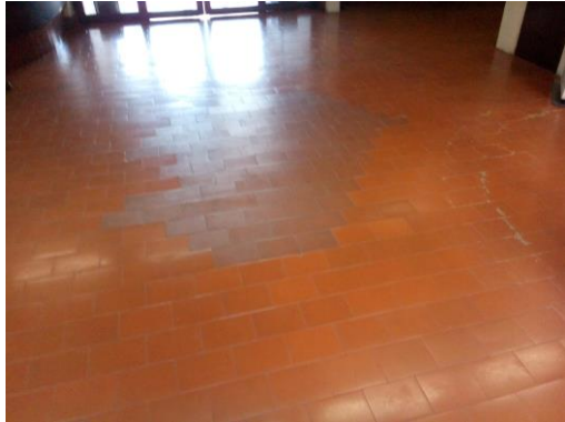
Figura 41 – Reparação pouco cuidada do pavimento no interior do edifício
