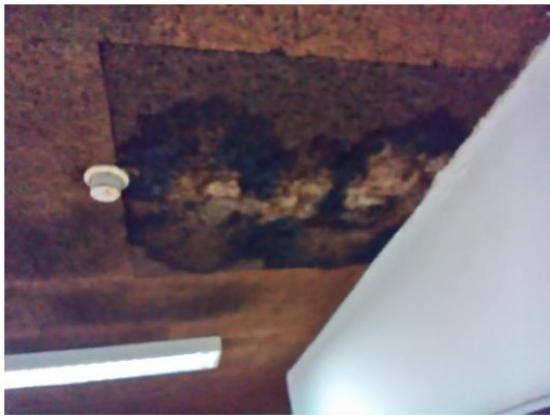
Figura 37 – manifestação de infiltração no aglomerado de cortiça que reveste o teto
