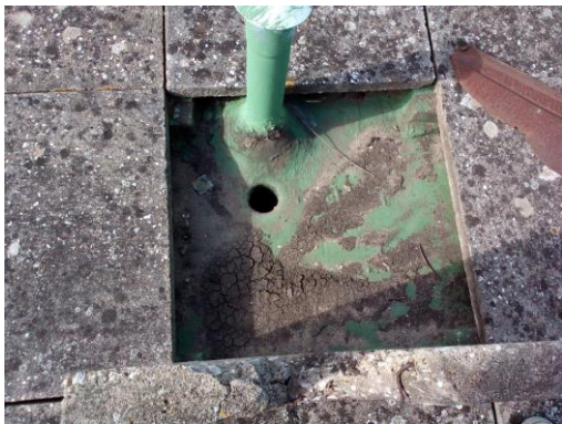
Figura 39 – Deposição de resíduos por mau escoamento
