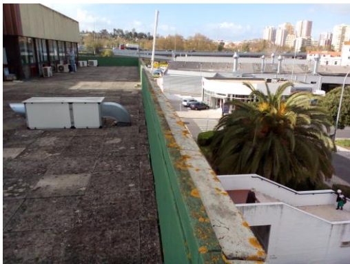
Figura 43 – Colonização biológica no topo da platibanda
