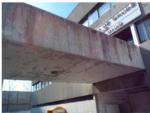
Figura 9 – Escada de acesso à porta principal com patologias de pintura
