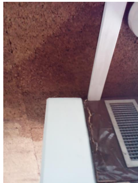
Figura 22 – infiltrações junto da corete
