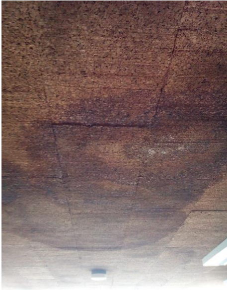
Figura 23 – Infiltração manifestada no revestimento do teto
