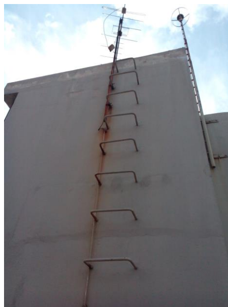
Figura 32 – Corrosão de elemento salientes
