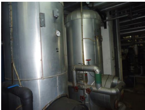
Figura 25 – Caldeiras a gás na cave do edifício
