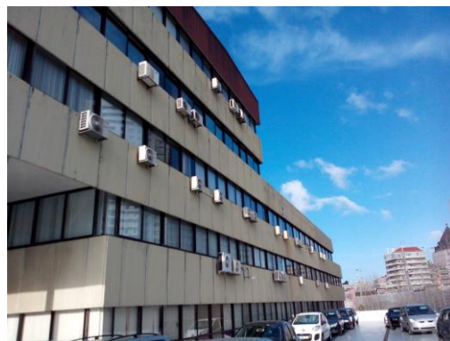
Figura 46 – Unidades exteriores de ar condicionado na fachada sul
