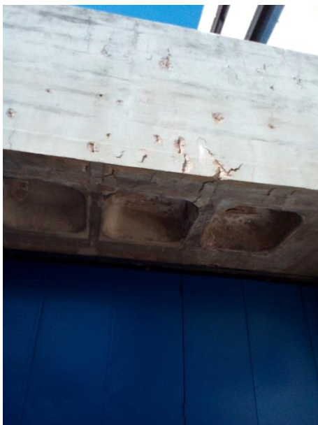
Figura 3 – Degradação do betão na platibanda e laje
