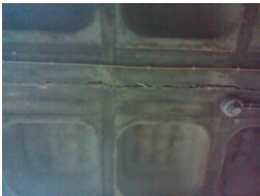
Figura 27 – fissura na laje da cave
