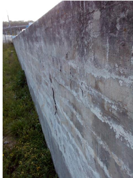
Figura 42 – Degradação do betão dos muros circundantes do edifício
