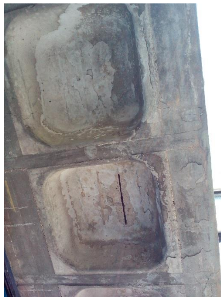
Figura 4 – Degradação do betão na laje
