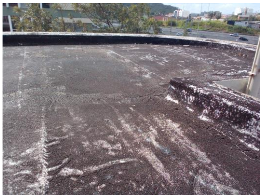
Figura 31 – Degradação da impermeabilização da escada de serviço
