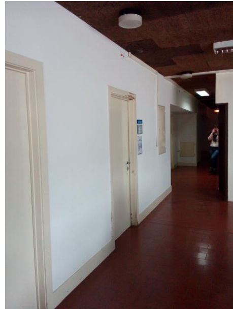
Figura 24 – Porta de gabinete com ligeira degradação
