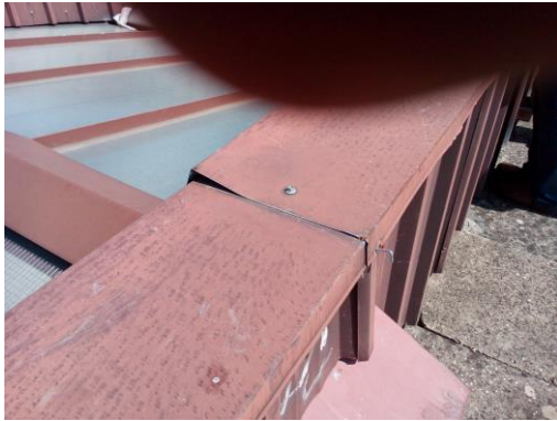
Figura 15 – Elementos metálicos empenados
