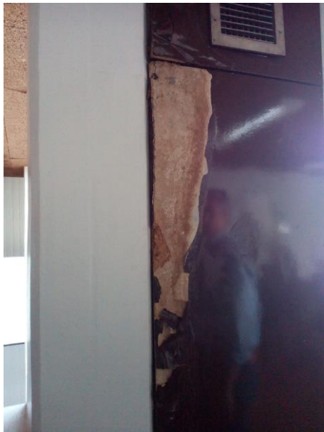
Figura 21 – Degradação do painel de contraplacado que reveste a corete
