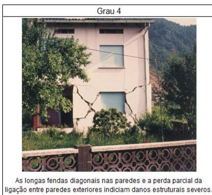
Figura 4.23 – Estrutura em alvenaria não armada com placa com danos de grau 4. Sismo de Friuli, Itália (1976). Local: Gemona (Udine) (Grünthal, 1998).
