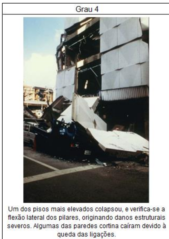
Figura 4.33 – Estrutura de aço com danos de grau 4. Sismo de Great Hanshin, Japão (1995). Local: Kobe. (Grünthal, 1998).
