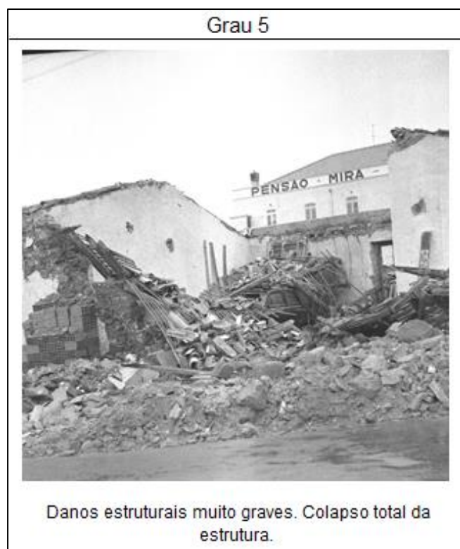
Figura 4.29 – Estrutura com paredes de adobe com danos de grau 5. Sismo de 1969, Algarve (Marecos & Castanheta, 1970; Sousa, 2006).
