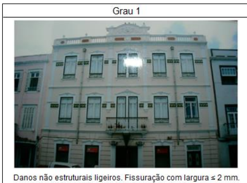
Figura 4.15 – Estrutura em alvenaria com danos de grau 1. Sismo do Faial (Açores) de 1998 (Ferreira & Oliveira, 2008).
