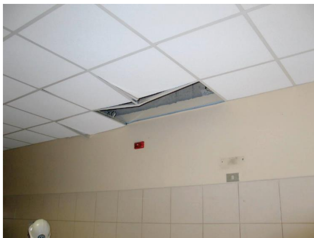
Figura 4.35 – Queda de placas do teto falso no Hospital de Talca na sequência do sismo do Chile de 2010 (FEMA, 2012).
