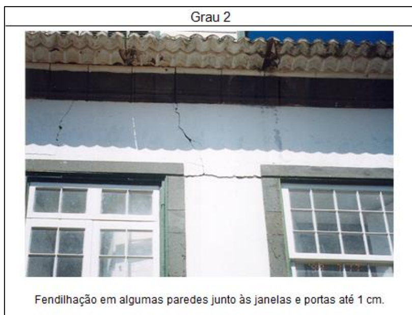
Figura 4.17 – Estrutura com paredes resistentes de alvenaria de pedra com danos de grau 2 (Marecos & Castanheta, 1970).
