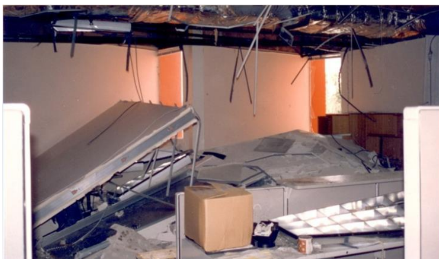
Figura 4.39 – Queda de paredes divisórias de escritório, tetos falsos e iluminação no sismo de Northridge de 1994 (FEMA, 2012).
