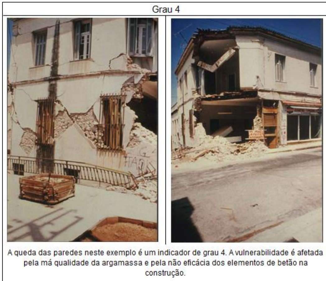
Figura 4.26 – Estrutura em alvenaria de pedra solta com danos de grau 4. Sismo de North Peloponissos, Grécia (1995). Local: Aegion. (Grünthal, 1998).
