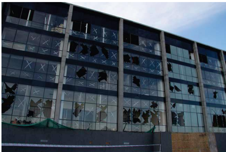
Figura 4.38 – Queda de envidraçados em muitos edifícios habitacionais e comerciais e hospitais na sequência do sismo do Chile de 2010 (FEMA, 2012).
