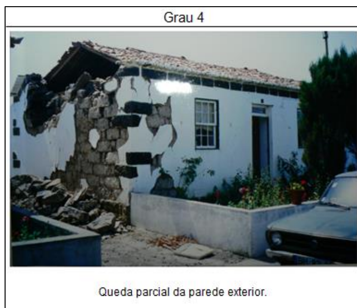
Figura 4.22 – Estrutura em alvenaria com danos de grau 4. Sismo do Faial (Açores) de 1998 (Ferreira & Oliveira, 2008).
