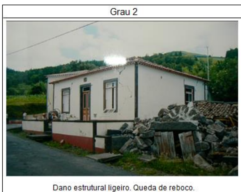
Figura 4.16 – Estrutura em alvenaria com danos de grau 2. Sismo do Faial (Açores) de 1998 (Ferreira & Oliveira, 2008).
