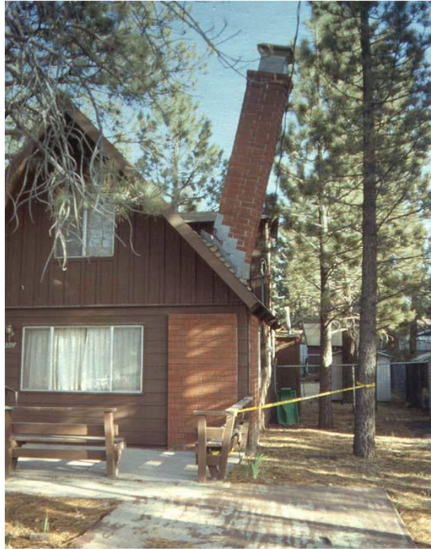
Figura 4.37 – Chaminé inclinada com área interdita (ATC, 1999).
