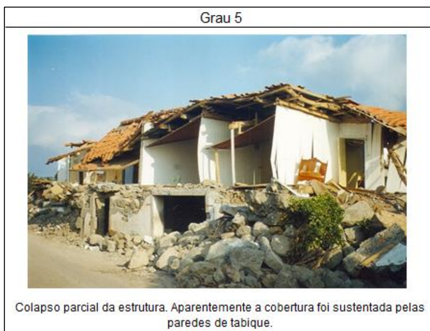
Figura 4.30 – Estrutura em alvenaria de pedra com danos de grau 5 (Marecos & Castanheta, 1970).
