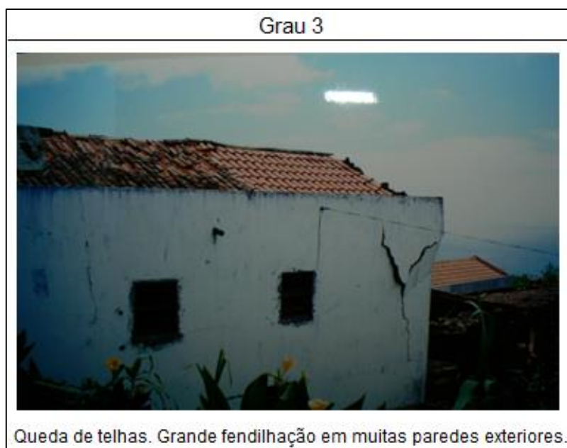
Figura 4.19 – a) Estrutura em alvenaria com danos de grau 3. Sismo do Faial (Açores) de 1998 (Ferreira & Oliveira, 2008).
