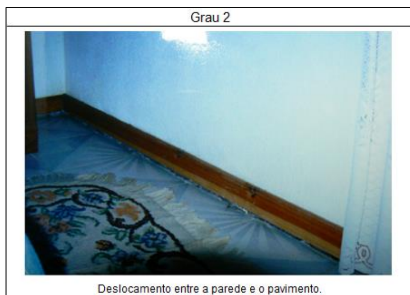
Figura 4.7 – Estrutura de betão armado com danos de grau 2. Sismo do Faial (Açores) de 1998 (Ferreira & Oliveira, 2008).
