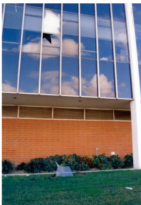
Figura 4.36 – Queda de um vidro não temperado na sequência do sismo de Northridge de 1994 (FEMA, 2012).
