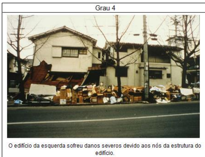
Figura 4.34 – Estrutura de madeira com danos de grau 4. Sismo de Great Hanshin, Japão (1995). Local: Kobe. (Grünthal, 1998).
