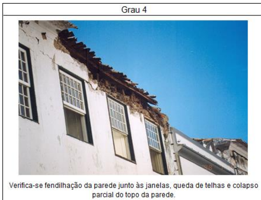
Figura 4.27 – Estrutura em alvenaria de pedra com danos de grau 4. Sismo do Faial (Açores) de 1998 (Ferreira & Oliveira, 2008).
