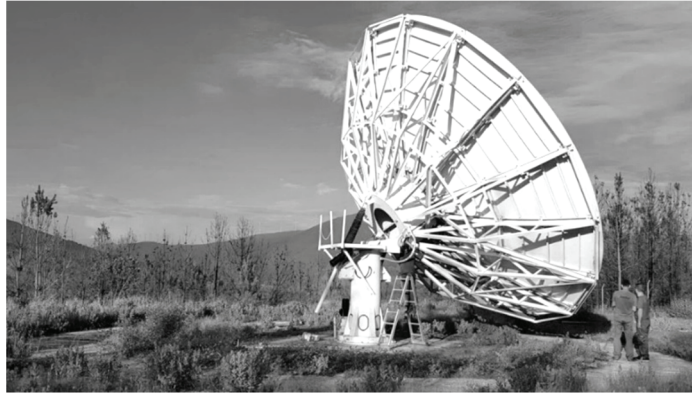
Figura 3.7 - Controlo de antena parabólica com posicionador absoluto.
