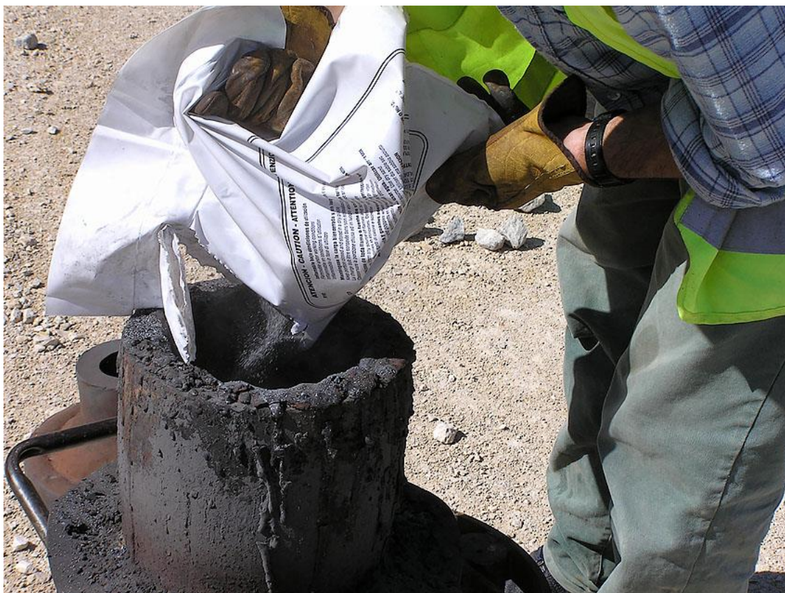
Figura 5.6 - Cargas aluminotérmicas - [Modernização do Troço Bombel e Vidigal a Évora]
