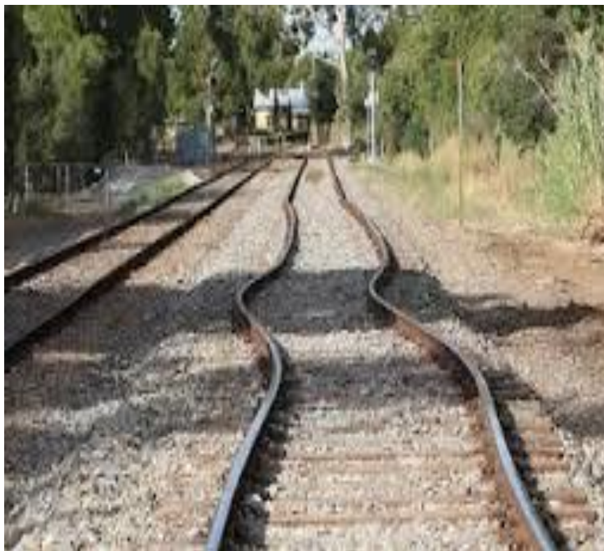
Figura 4.1 – Consequência da não regularização de tensões - [Web]
