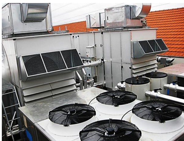
Figura 31 – Centro de Atendimento Permanente em Seia (antes da intervenção) - “Chillers” e ventiladores de extracção na cobertura plana
