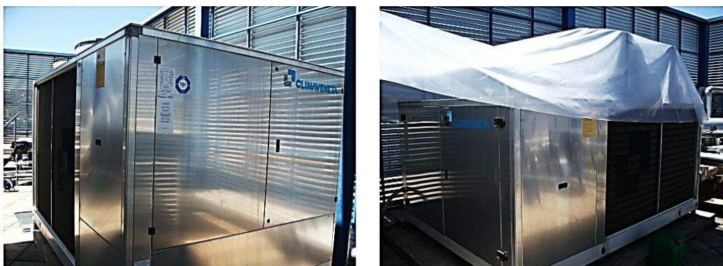
Figura 18 – Edifício Sede de Escritórios em Coimbra (Auditoria Energética) - “Chiller” e Bomba de calor
