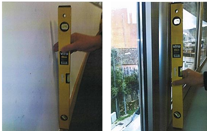
Figura 3 - Edifício Sede de Escritórios em Coimbra (patologias do edifício) - Inclinações da parede e da caixilharia metálica
