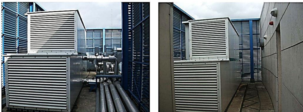
Figura 19 - Edifício Sede de Escritórios em Coimbra (Auditoria Energética) - UTAN A e UTAN B
