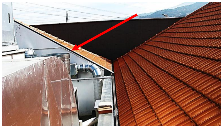
Figura 32 - Centro de Atendimento Permanente em Seia - Chaminés de exaustão nos ventiladores
