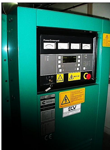
Figura 23 - Edifício Sede de Escritórios em Coimbra (Auditoria Energética) - Grupo de emergência
