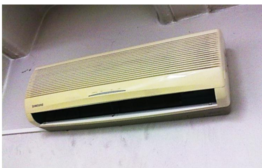
Figura 21 – Edifício Sede de Escritórios em Coimbra (Auditoria Energética) - “Split”
