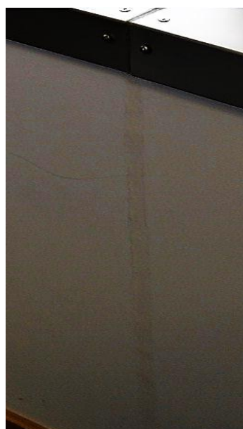
Figura 16 - Edifício Sede de Escritórios em Coimbra - Junta de dilatação na parede de suporte da caixilharia metálica
