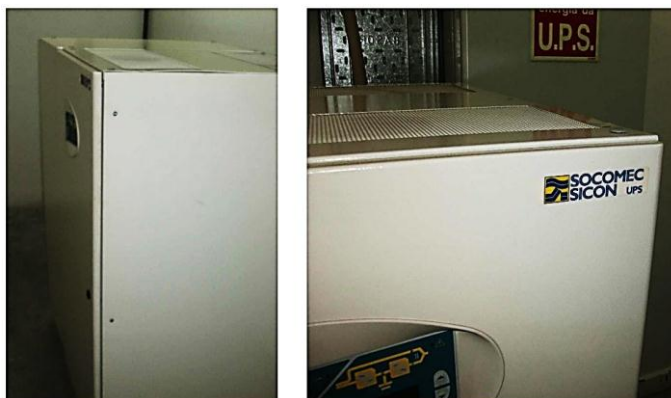
Figura 22 - Edifício Sede de Escritórios em Coimbra (Auditoria Energética) - UPS
