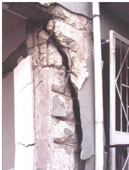
FIGURA 2.11 – Ausência de armadura de confinamento adequada (Izmit, 1999) [5]
