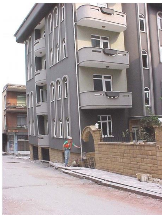
FIGURA 2.4 – Assentamento do edifício devido ao fenómeno de liquefação [5]
