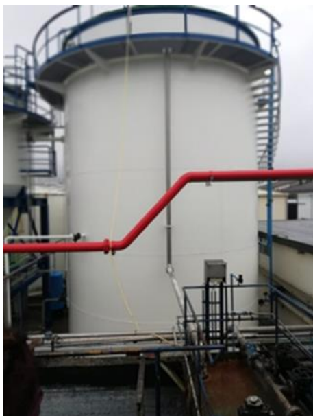
Figura 10 - Tanque de arejamento – vista lateral
