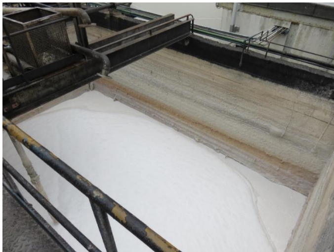
Figura 8 - Tanque de equalização I
