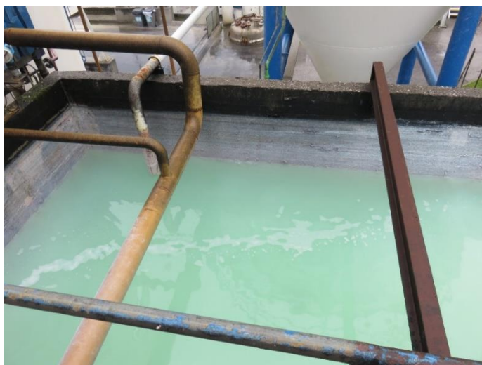
Figura 9 - Tanque de equalização II
