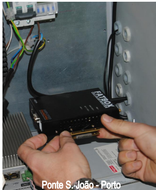
Figura 5.5 – Router Fatbox Obra monitorizada pelo NOE
