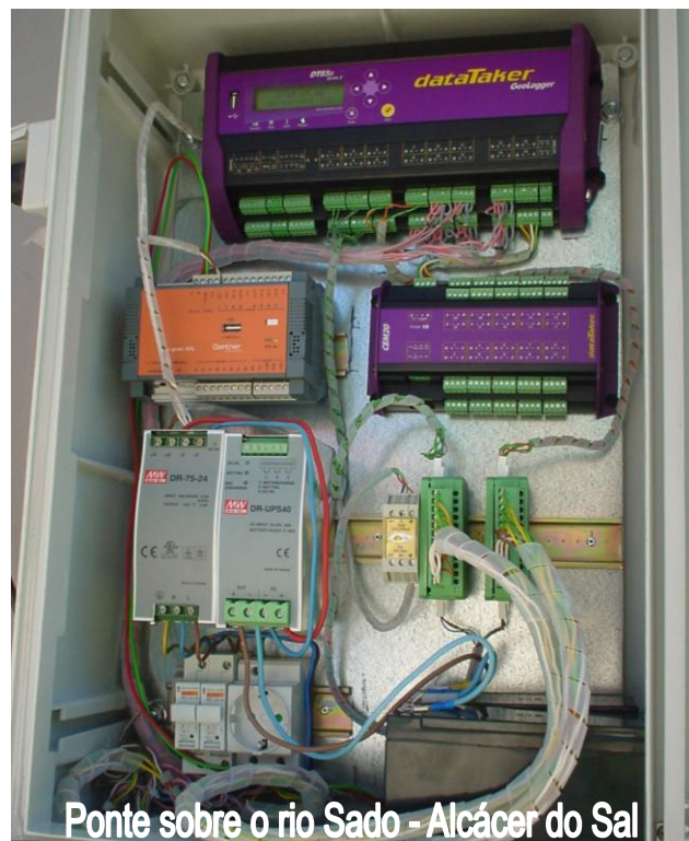
Figura 5.4 – Data logger e expansor de canais Obra monitorizada pelo NOE
