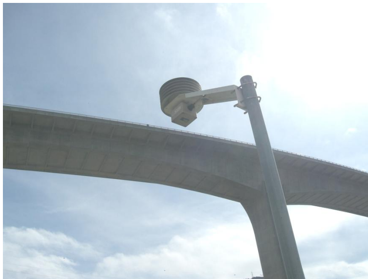
Figura 4.6 – Sensor termo-higrométrico Obra monitorizada pelo NOE - Ponte Miguel Torga – Régua
