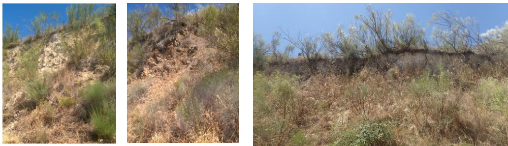
Figura 3.8 – Ravinamentos de taludes
