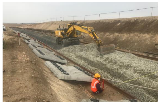
Figura 5.37 – Abertura caixa de balastro
