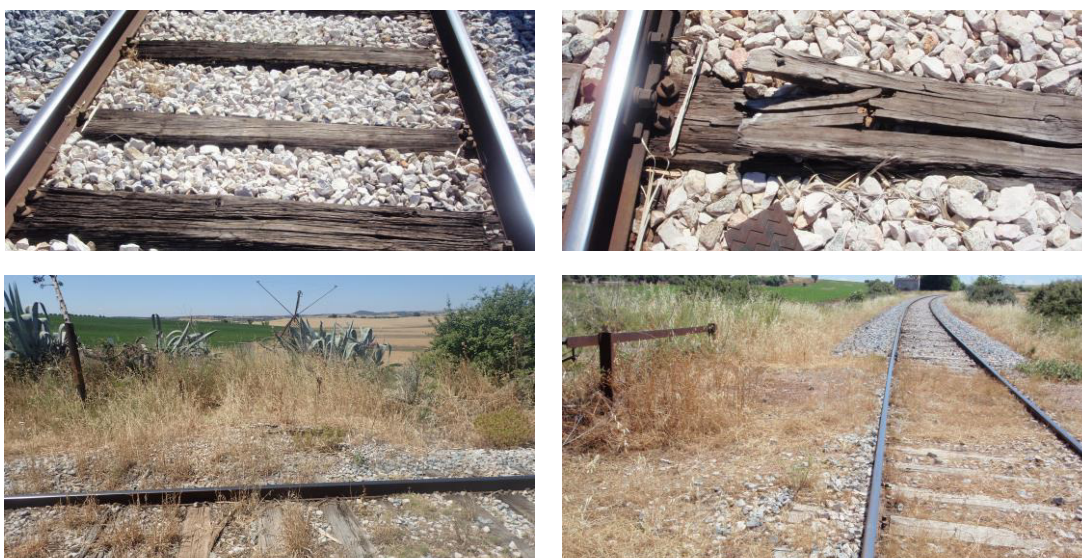
Figura 3.6 – Armamento de Via degradado
