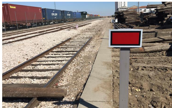
Figura 5.11 – Sinal de Barragem
